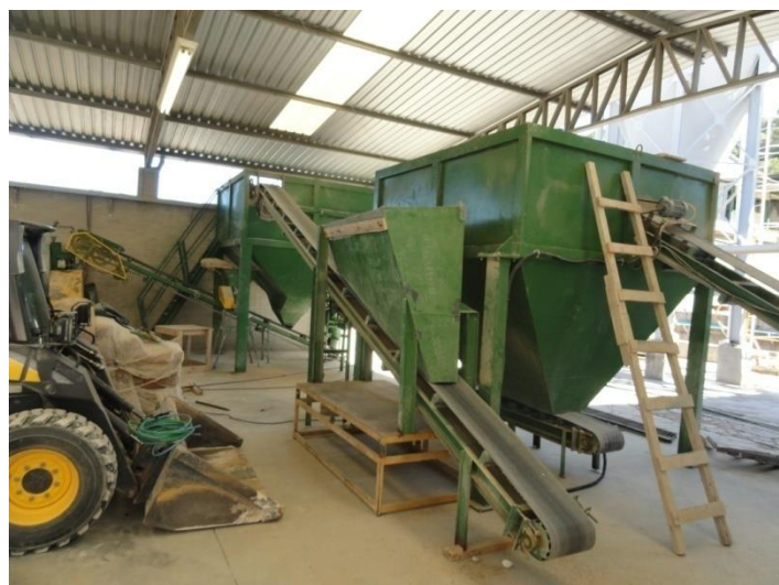
Figura 7.28: Parte da usina de transformação da LBRO em tijolos ecológicos.
