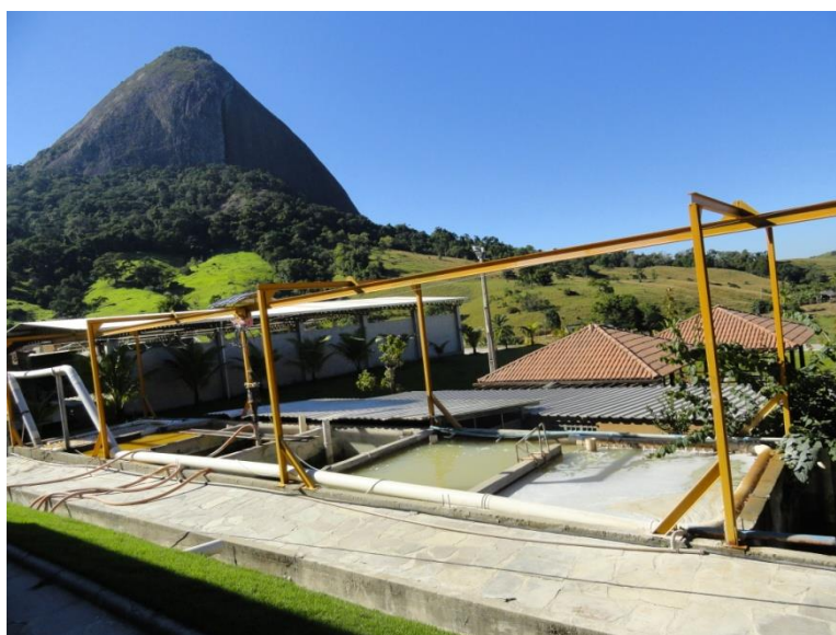
Figura 7.30: Sistema de tratamento de efluentes líquidos.
