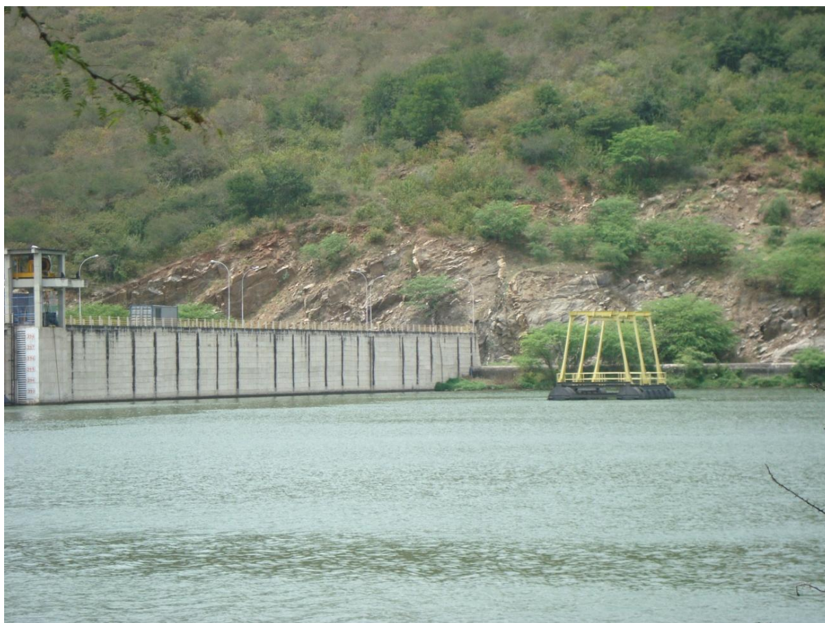
Figura 3.28- Flutuante construído para captação de água superficial na barragem. Fonte: Barbosa, 2011.
