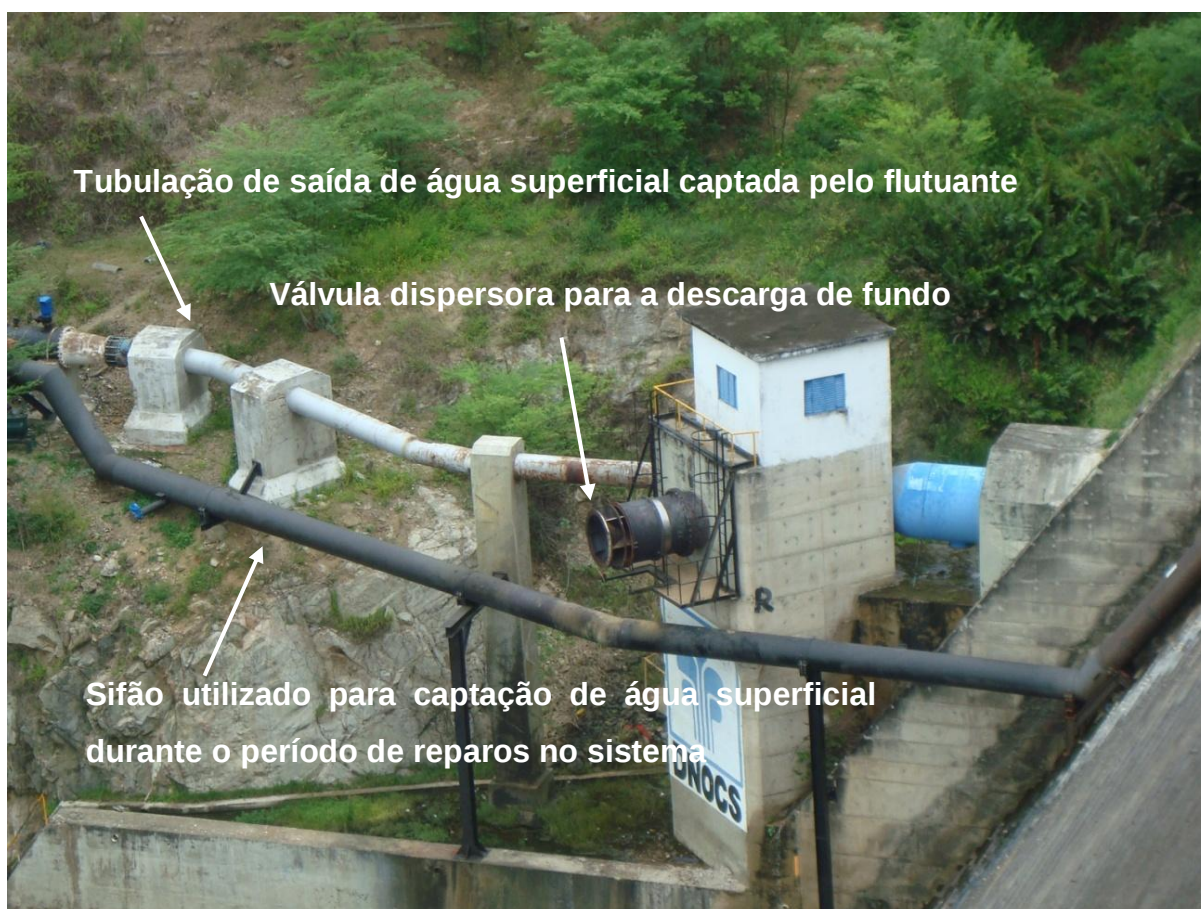
Figura 3.31- Sifão, válvula dispersora para descarga de fundo e tubulação de saída de água captada pelo flutuante. Fonte: Barbosa, 2011.
