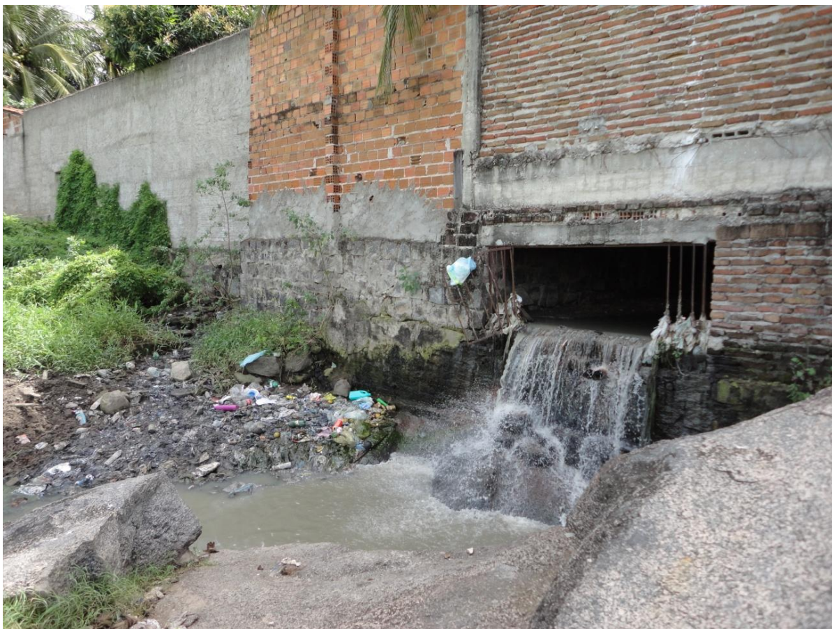
Figura 3.21- Lançamento de esgoto no rio Capibaribe em Toritama. Fonte: Barbosa, julho/2011.
