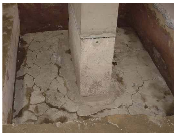
Figura 41 - Bloco de fundação de um edifício comercial com 25 anos de idade, localizado na Região Metropolitana de Recife.
