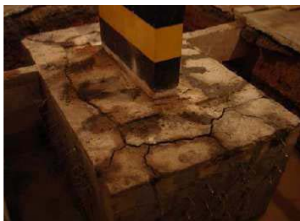
Figura 40 - Bloco de fundação de edificação residencial com 9 anos de idade, localizado na Região Metropolitana de Recife.
