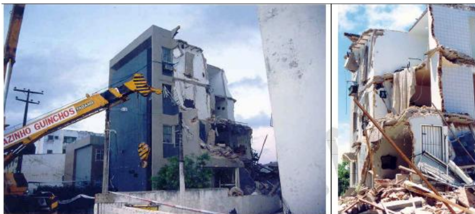
Figura 2.3 - Edifício Érika - Ruína - Olinda - PE
