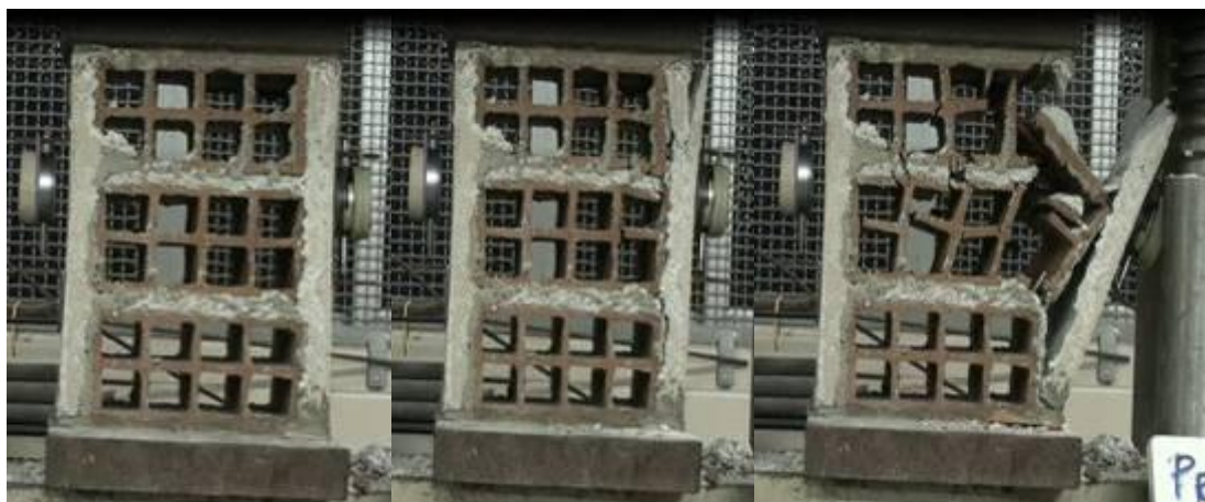
Figura 4.11 - Ruptura do prisma ao chato e traço 1:2:9 revestimento 20 mm
