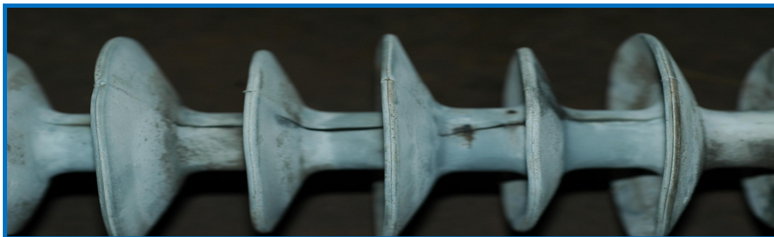
Figura 440 - Detalhe do Isolador onde verifica-se várias cavidades de forma longilínea.
