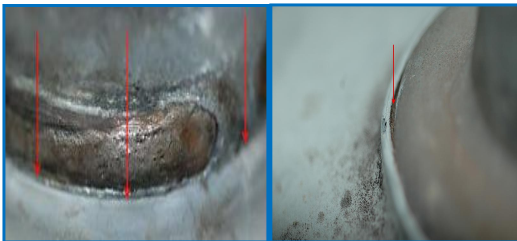
Figura 484 - Detalhe do Isolador onde verifica-se diversos pontos por onde pode ter ocorrido a penetração de umidade.
