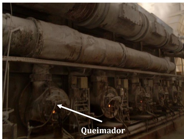
Figura 4-1 - Forno rotativo de queima indireta (Calcinadora Supergesso).
