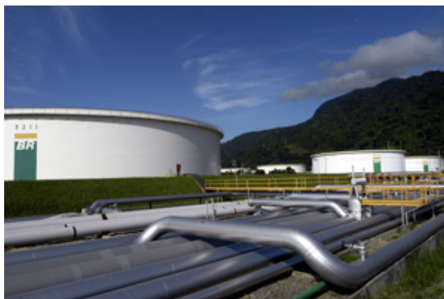
FIGURA 2 - EXEMPLO DE UMA DUTOVIA DA PETROBRAS
