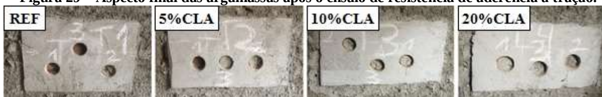
Figura 29 – Aspecto final das argamassas após o ensaio de resistência de aderência à tração.
