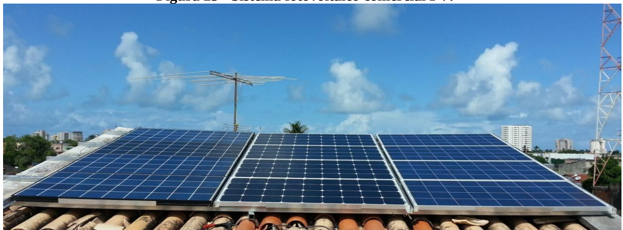
Figura 25 - Sistema fotovoltaico comercial FV.
