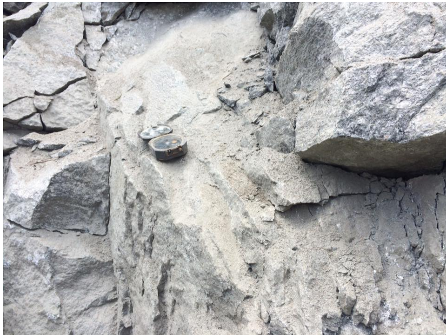
Figura 13. Fratura no maciço rochoso da pedreira Combritas.
