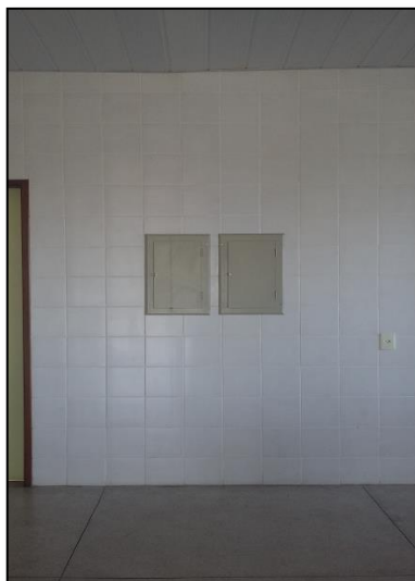
Figura 22 – Piso e parede dos LEQs/NIATE
