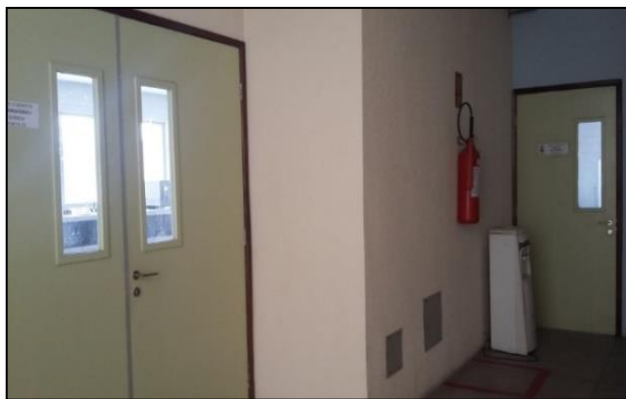
Figura 40- Extintor na parte externa e porta de emergência do LEQ2/NIATE.
