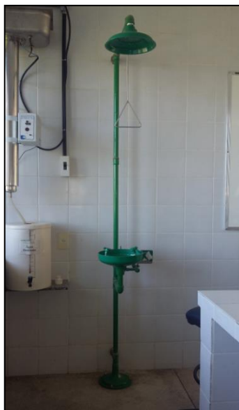
Figura 27 –Chuveiro de emergência acoplado ao lava-olhos no LEQ/NIATE.
