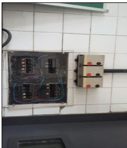
Figura 14– Quadro de força do LEQ1/DQF
