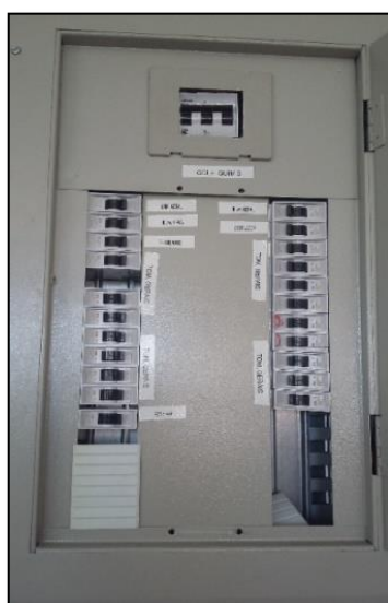
Figura 29– Quadro de força LEQ/NIATE
