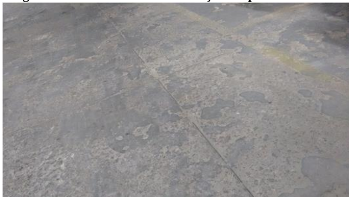
Figura 39 – Problema de delaminação em pisos de concreto.
