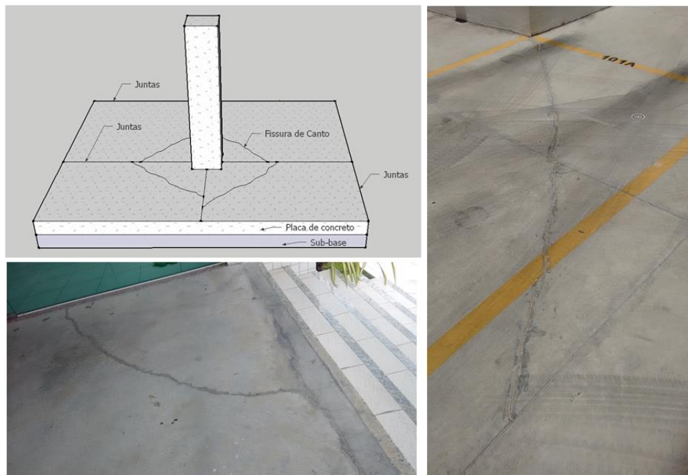
Figura 29 – Fissuras de canto em pisos de concreto.
