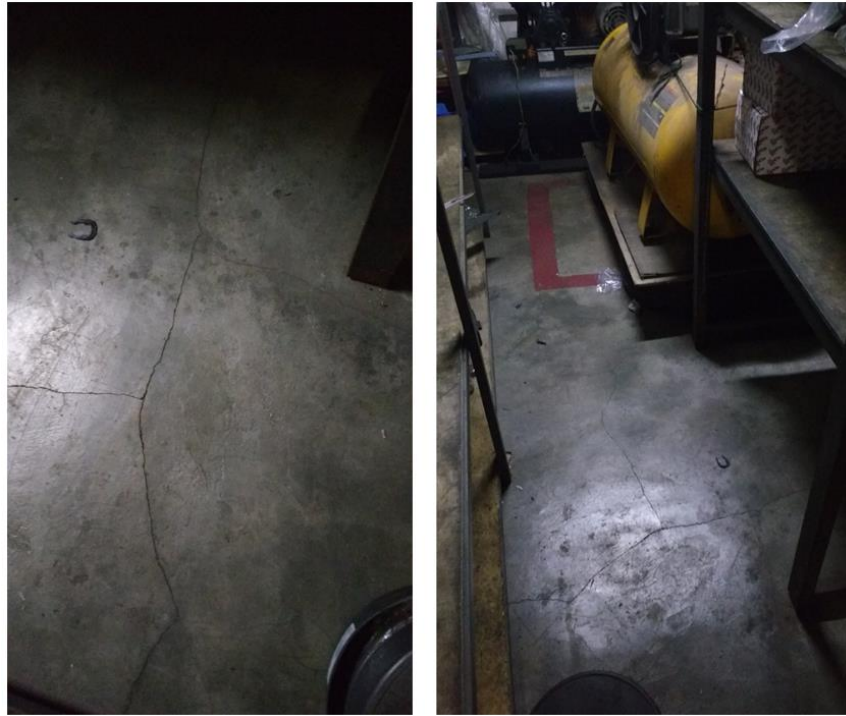
Figura 35 – Piso de concreto com rompimento da placa.
