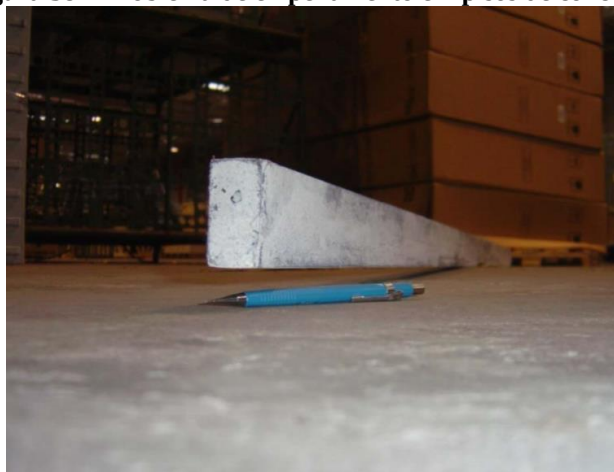
Figura 38 – Problema de empenamento em pisos de concreto.
