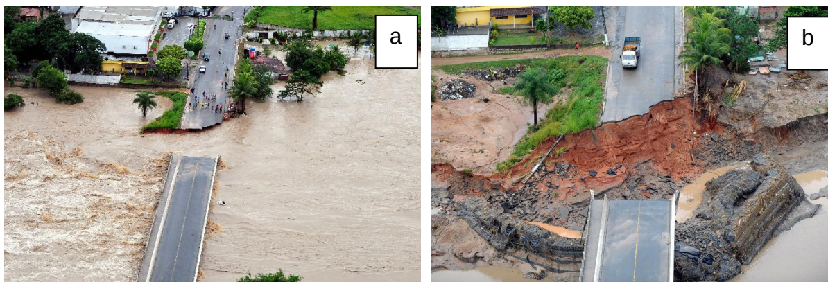
Figura 7 – Viaduto Profa. Lúcia Paiva, destruído pela inundação do rio Una, no município de Palmares. (7a) no dia 19/06/2010; (7b) no dia 23/06/2010.
