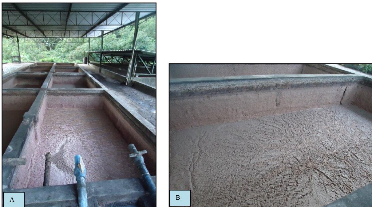
Figura 2. Vista geral dos tanques de decantação (A), detalhe do tanque de coleta (B) da Estação de Tratamentos de Resíduos da Sorveteria Zeca's.
