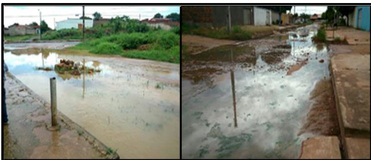
Fotografia 9 – Imagens destacando problemas de escoamento de águas pluviais em ruas do Bairro Santo Antônio, Teresina, PI.
