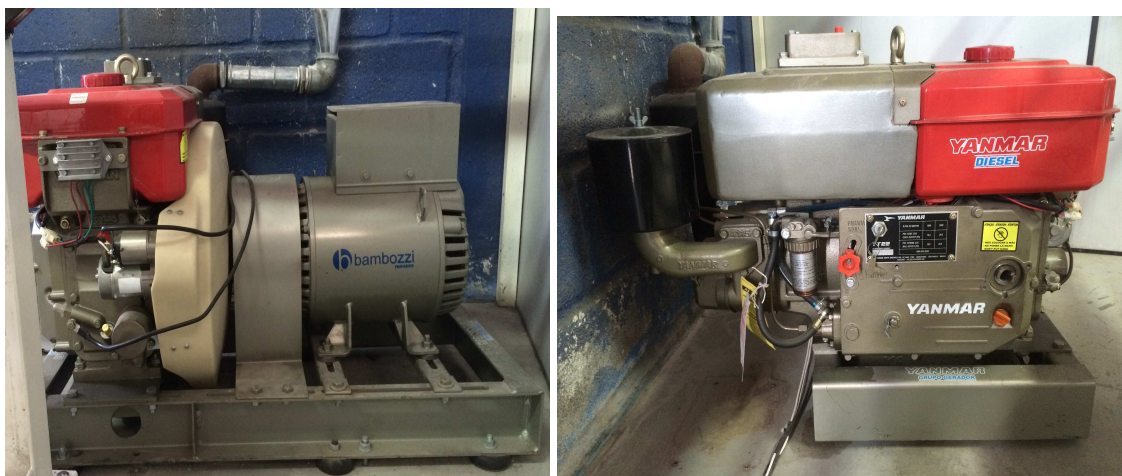
Figura 24 - Grupo motor-gerador do laboratório de modelo reduzido
