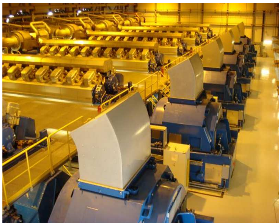
Figura 39 - Grupos motor-gerador da usina termelétrica
