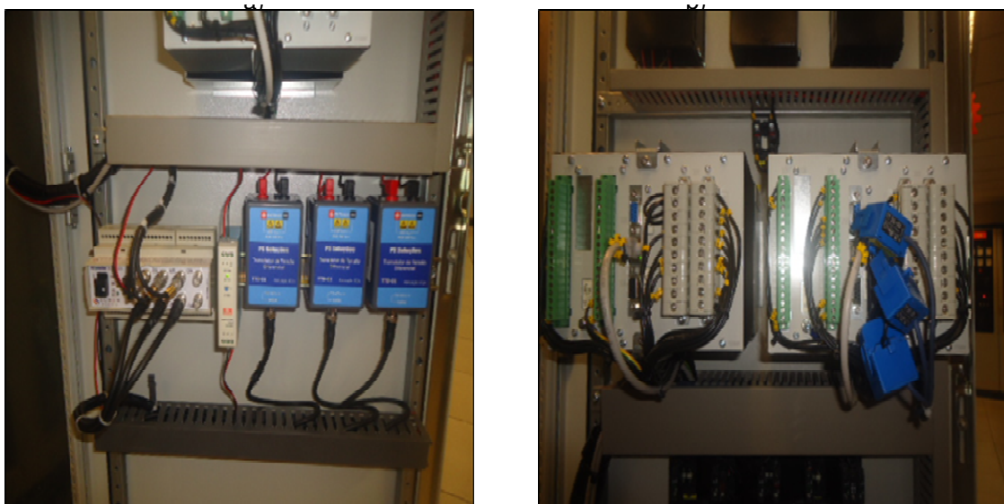
Figura 26 - Sistema de transdução e aquisição de sinais instalado na usina termelétrica. a) Detalhe do sistema de aquisição de dados e do transformador de tensão e b) Detalhe do transformador de corrente
