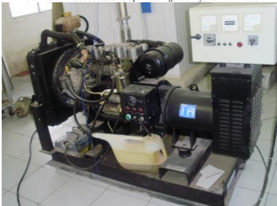
FIGURA 9 – Bancada de testes - Grupo motor – gerador Hyundai D4BB-AG31.
