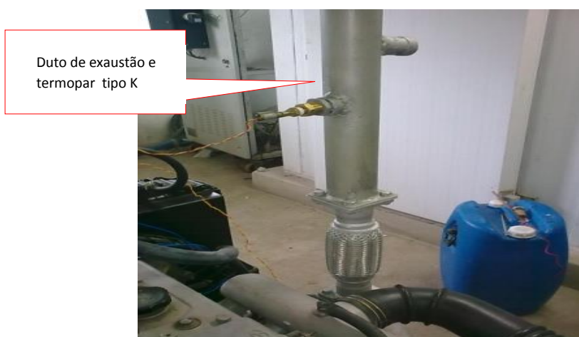
Figura 14 – Temperatura dos gases de exaustão.
