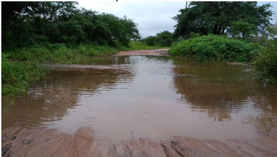
Figura 48 – Assentamento Todos os Santos/Chupete – Estrada de acesso à comunidade em péssimo estado.
