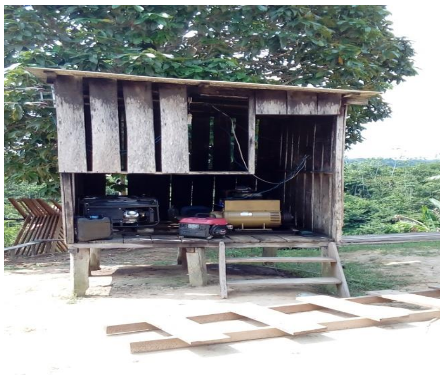
Figura 7 - Casa de máquinas dos geradores a diesel.
