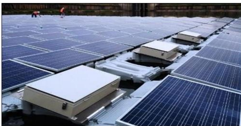
Figura 14- Exemplo da caixa de junção montadas nos flutuadores principais
