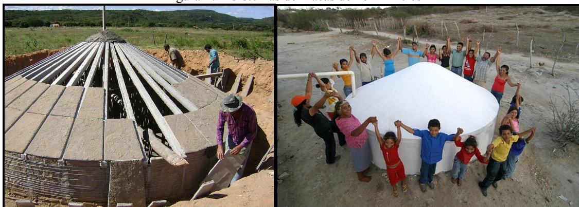
Figura 17 - Cisternas de Placas de 16 mil litros
