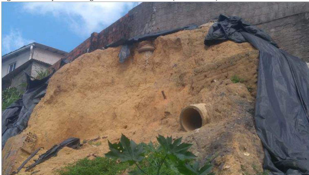
Figura 105 - Lançamento de água diretamente na encosta (seta vermelha) no bairro de Nova Descoberta.
