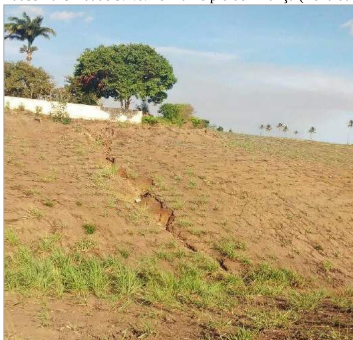
Figura 81 - Erosão ER0059 na Unidade 3.4.6. no município de Aliança (Zona da Mata Note).
