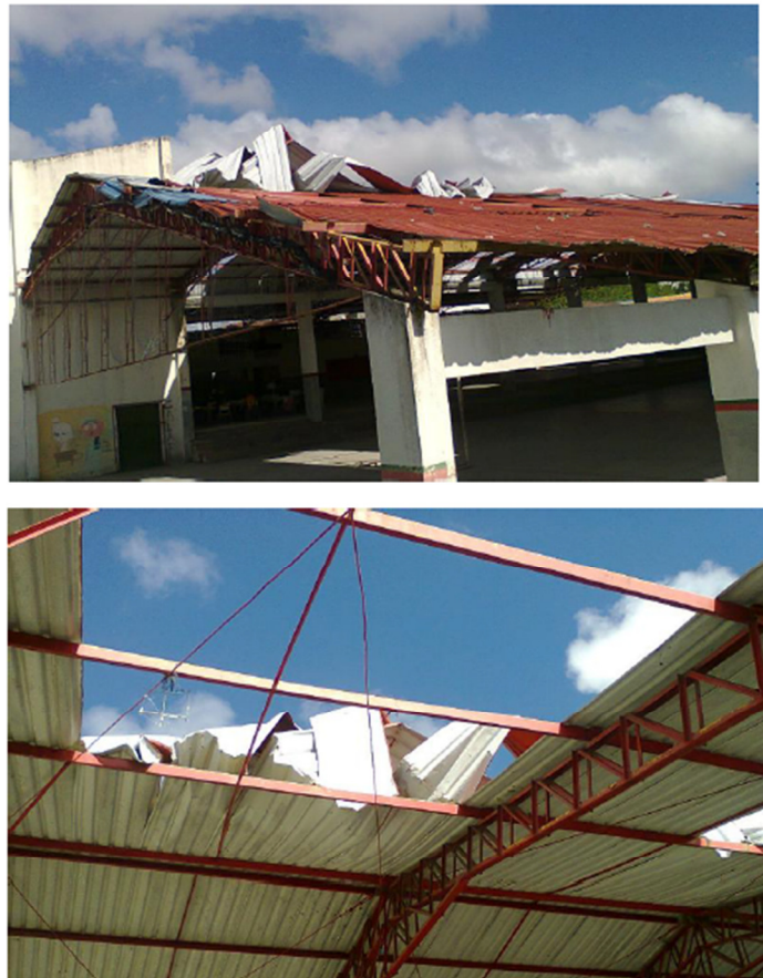
Figura 3 - Telhado da quadra danificado pela ação do vento.
