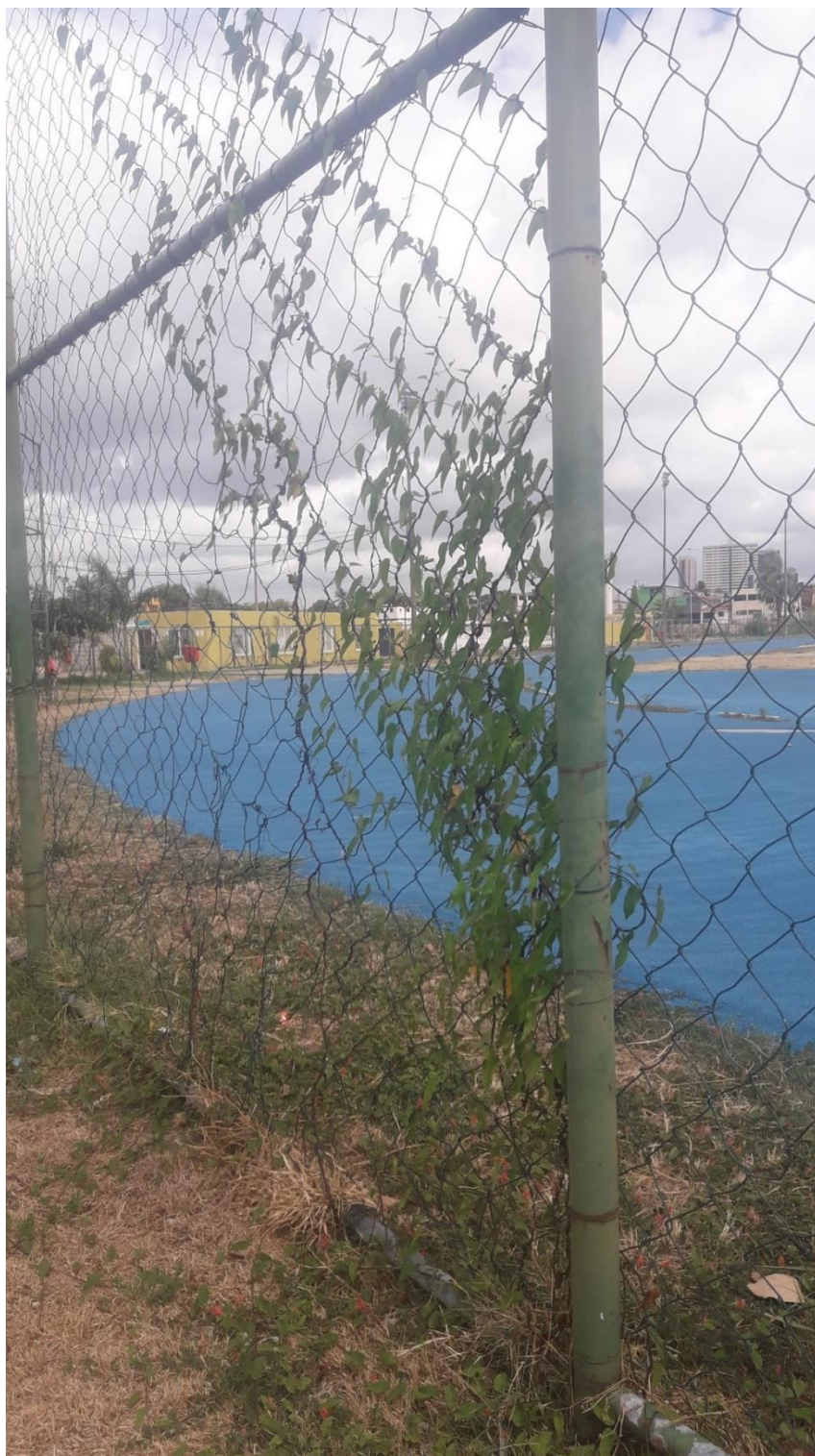
Figura 71 - Parque do Caiara – Pista de corrida e quadras sem manutenção e solo sem preservação, grades resgadas e enferrujadas, local sem frequentadores.
