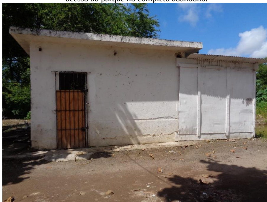
Figura 24 - Parque do Jiquiá – Zona Oeste, falta de manutenção e falta de investimentos, guarita de acesso ao parque no completo abandono.
