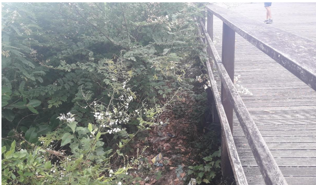
Figura 85 - Parque do Caiara – Área sem manutenção e solo sem preservação, local sem frequentadores.
