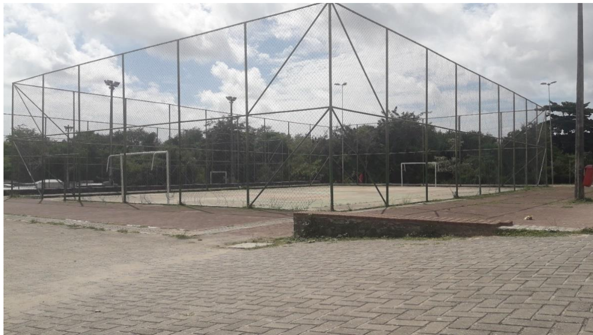
Figura 73 - Parque do Caiara – Pista de corrida e quadras sem manutenção e solo sem preservação, grades resgadas e enferrujadas, local sem frequentadores.
