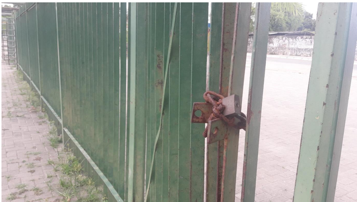
Figura 62 - Parque do Caiara – Entrada principal trancada, falta de manutenção constante, solo sem preservação, local sem frequentadores.
