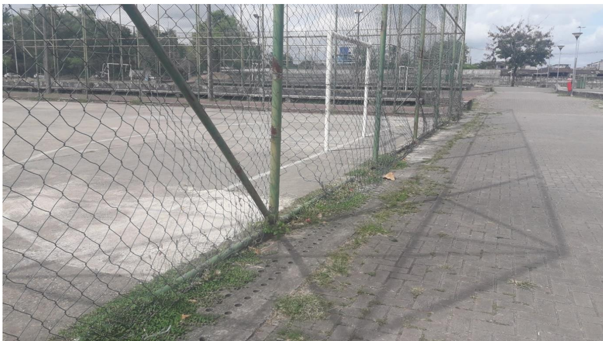
Figura 74 - Parque do Caiara – Pista de corrida e quadras sem manutenção e solo sem preservação, grades resgadas e enferrujadas, local sem frequentadores.
