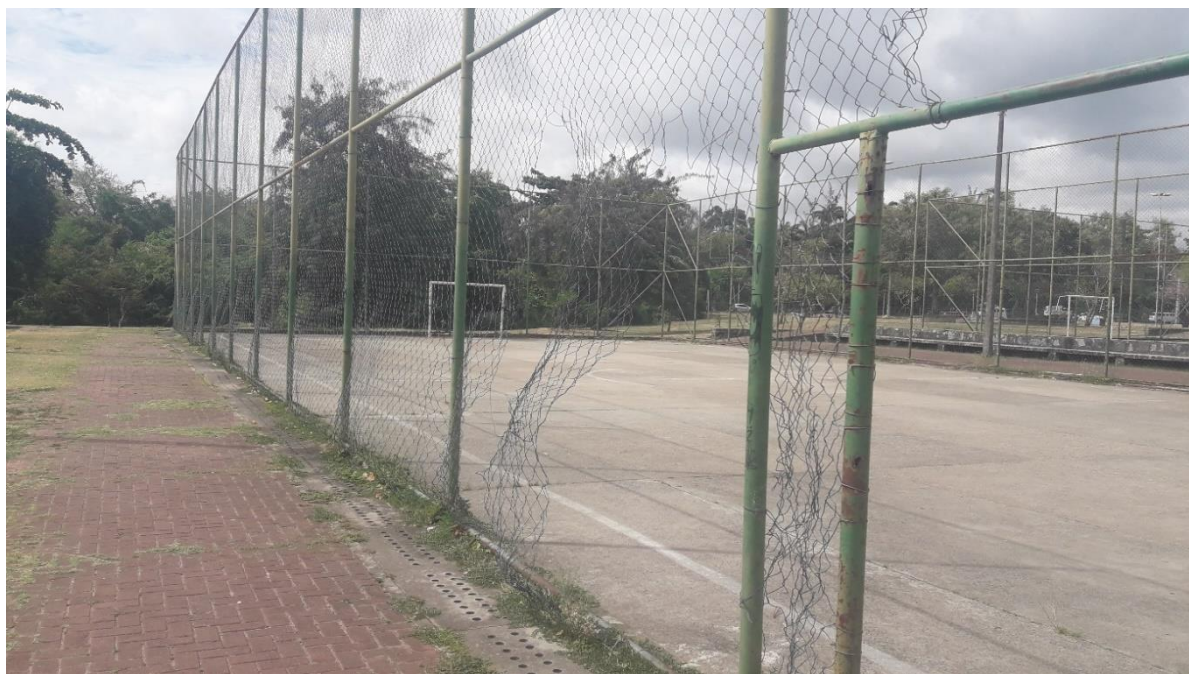
Figura 75 - Parque do Caiara – Pista de corrida e quadras sem manutenção e solo sem preservação, grades resgadas e enferrujadas, local sem frequentadores.
