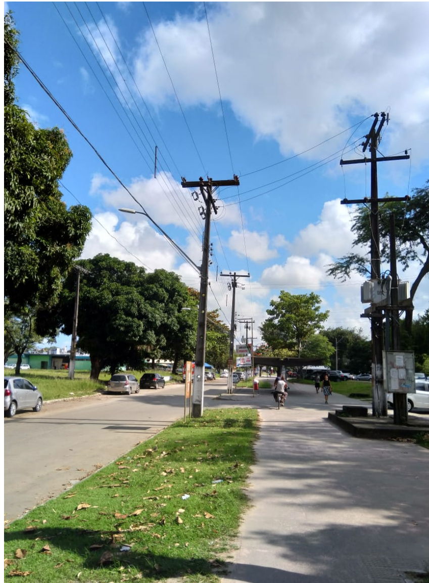
Figura 4 - Linha de distribuição de 13,8 kV no Campus da UFPE de Recife-PE
