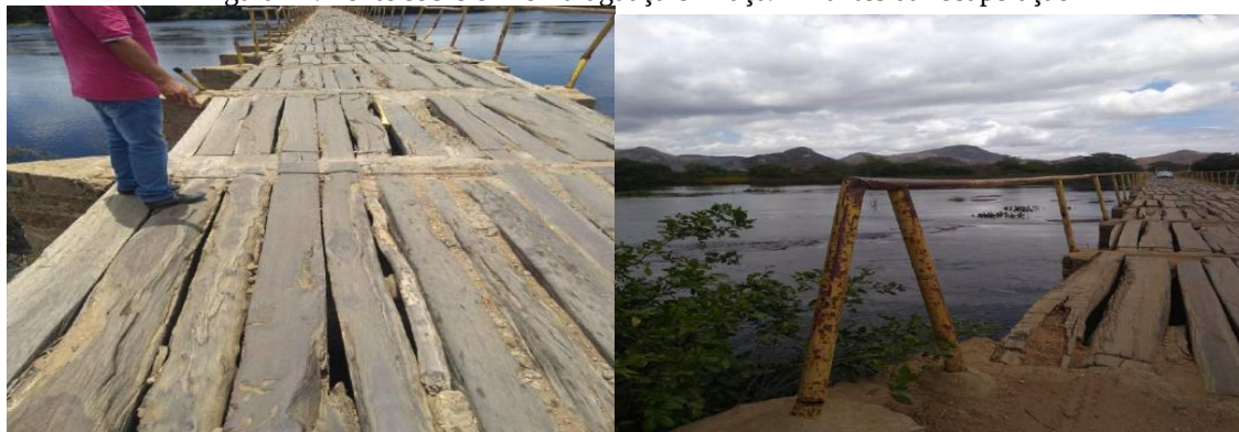
Figura 17: Ponte sobre o Rio Paraguaçu em Iaçu/BA antes da recuperação
