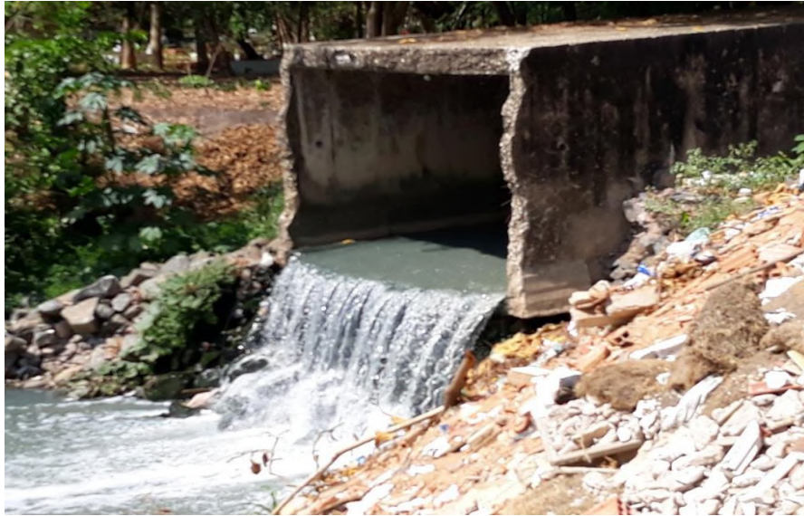
Figura 29 – Saídas de águas servidas in natura , Bueiro Areias
