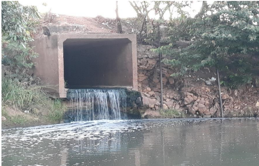
Figura 30 – Saídas de águas servidas in natura , Bueiro Balão da CEPISA
