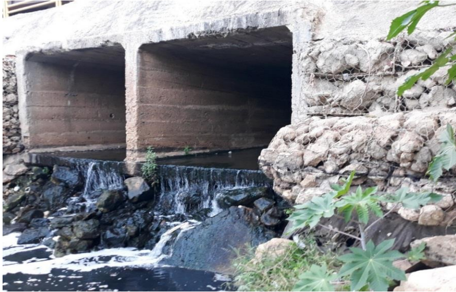
Figura 31 – Saídas de águas servidas in natura , bueiro Ponte da Amizade
