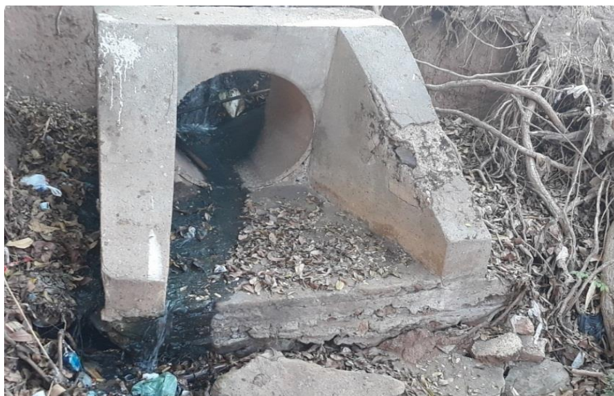
Figura 34 – Saídas de águas servidas in natura , bueiro Iate Clube
