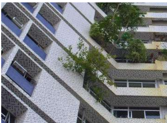
Figura 13 - Revestimentos em pastilhas do Edf. Villa da Praia
