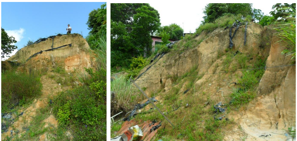
Foto 5.11 – Evidências de escorregamentos anteriores
