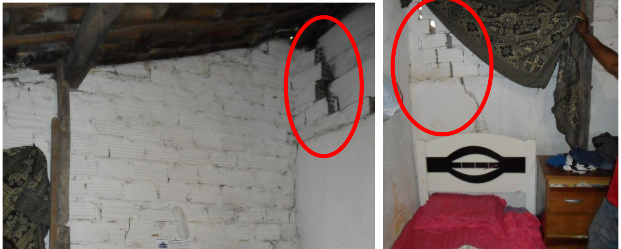
Foto 5.8 – Fissuras verificadas nas construções
