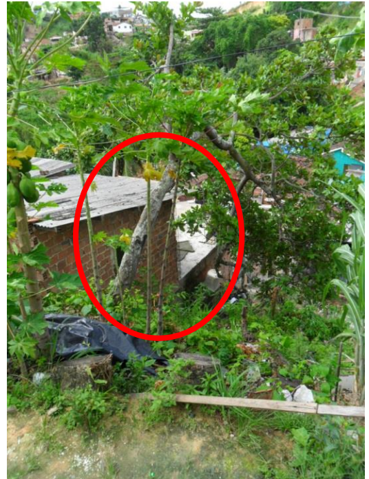
Foto 5.10 – Árvore no talude inclinada
