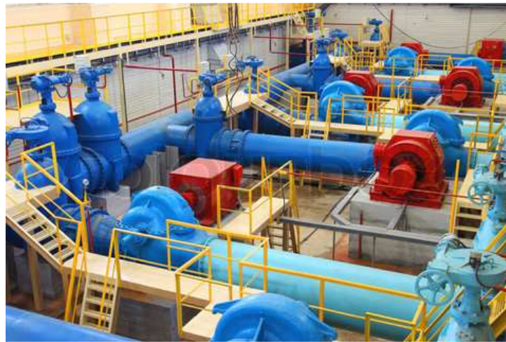
Figura 1.9 – Estação de distribuição de água.
