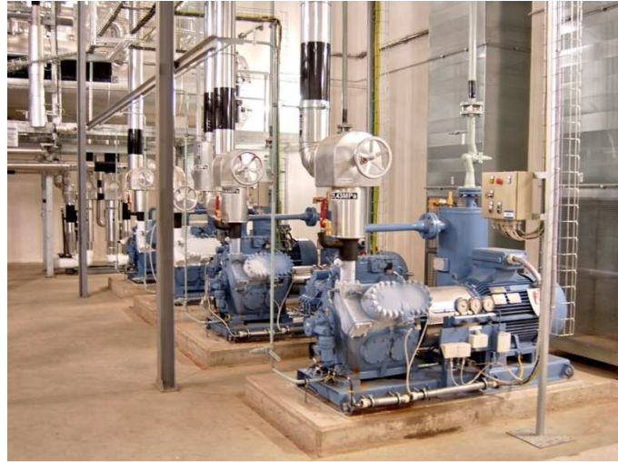
Figura 1.8 - Compressores de CO 2 .
