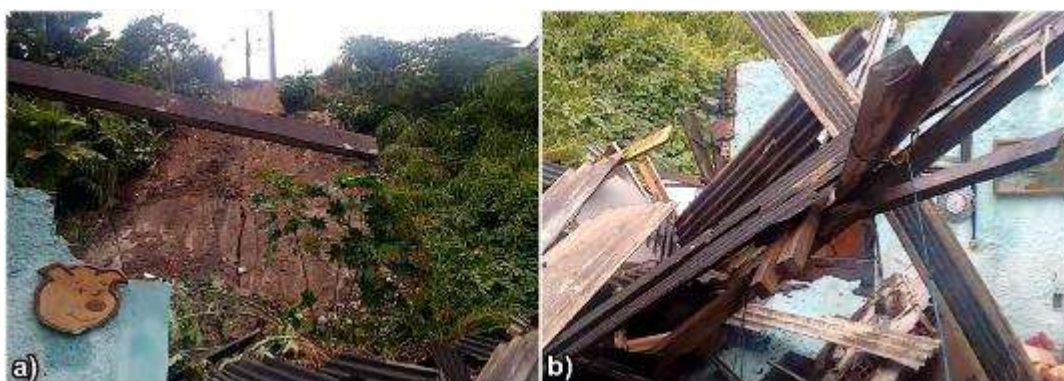
Figura 32 – Deslizamento na localidade Pantanal, COHAB, em 24/07/19: a) Ruptura; b) Destruição da residência atingida.
