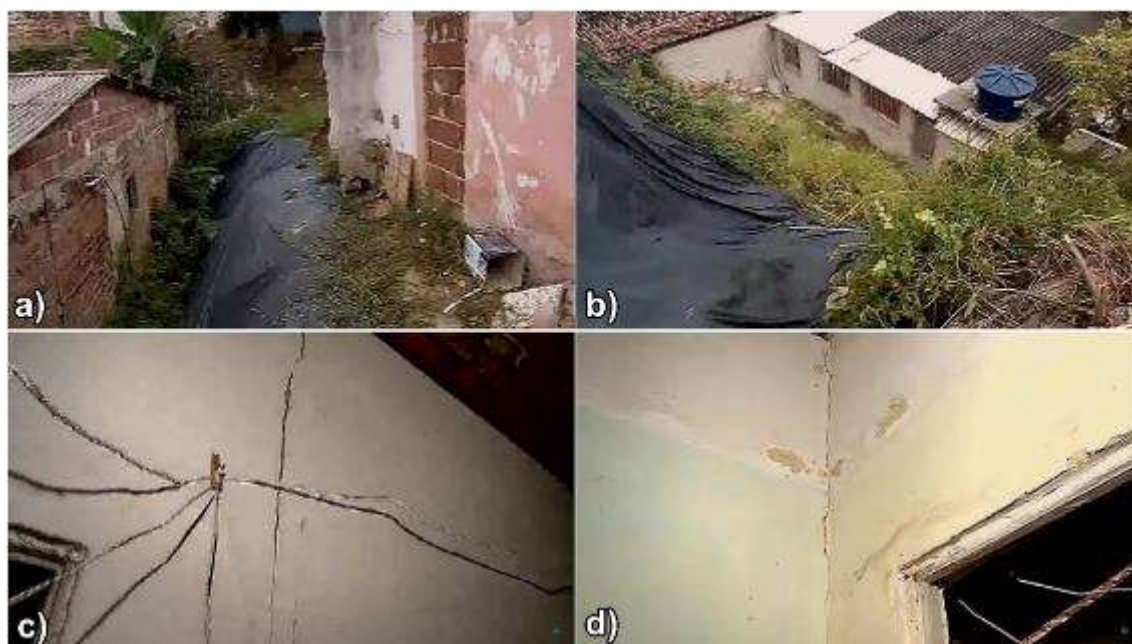
Figura 30 – Deslizamento na localidade Pantanal, COHAB, em 24/07/19: a) e b) Encosta; c) e d) Trincas e fissuras nas paredes da residência localizada no topo da encosta.
