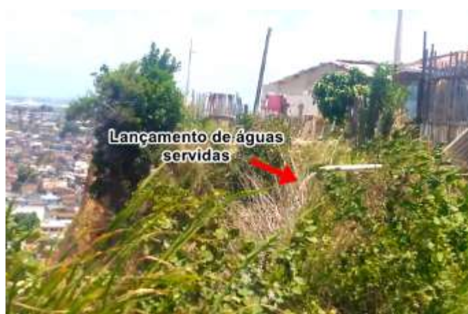
Figura 45 - Lançamento de águas servidas diretamente na encosta.
