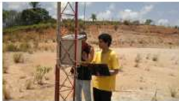
Figura 14 - Coletor de dados CR1000 instalado próximo à base da torre de medição.
