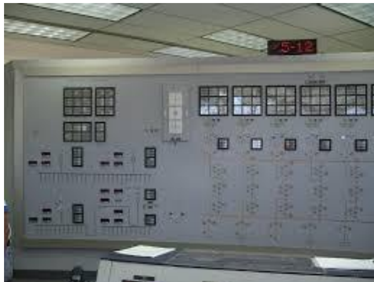
Figura 1 – Antigo painel de controle
