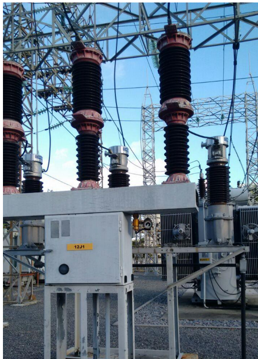
Figura 7 – Disjuntor de alta tensão (1600A/SF 6 ), SE Ilha do Retiro (Celpe).
