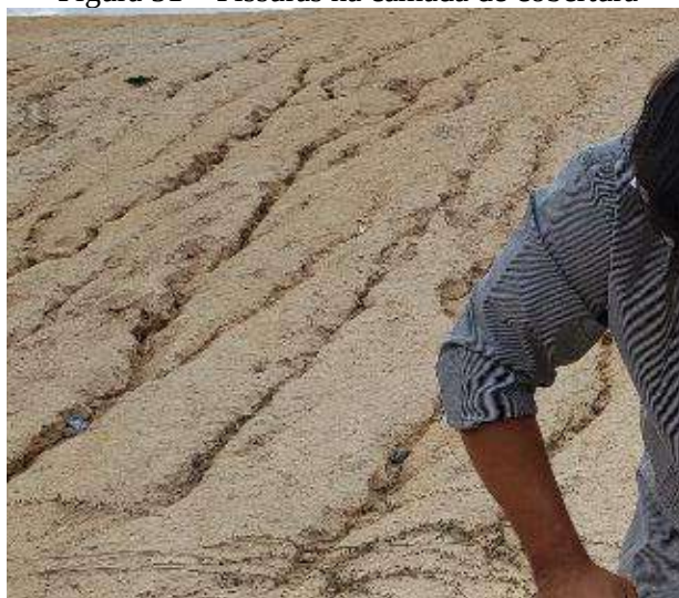
Figura 51 – Fissuras na camada de cobertura
