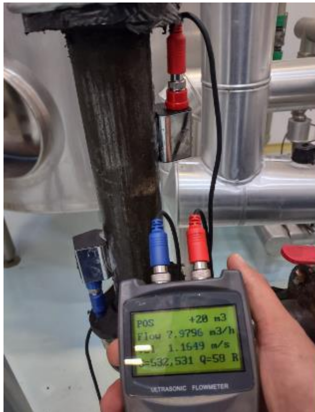
Figura 07. Exemplo da medição da vazão da água potável utilizando o medidor ultrassônico de vazão. Fonte: O Autor (2022).
