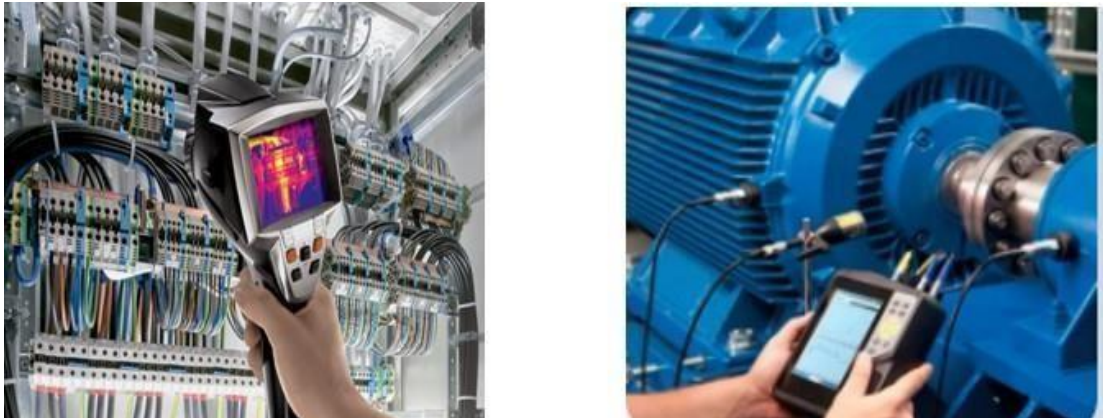
Figura 13 - – Esquerda - Análise termográfica, Direita - Análise de vibração em motor elétrico
