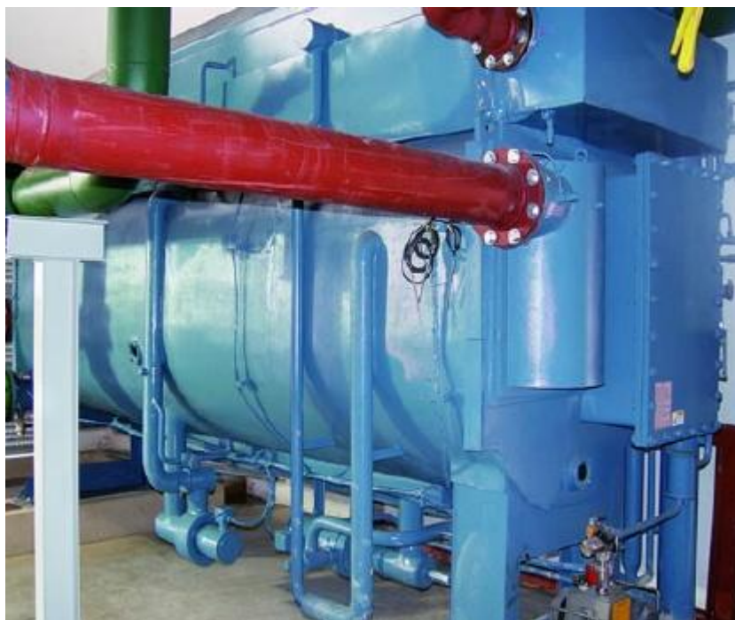
Figura 1.4. Chiller de absorção de brometo de lítio – água usada para a refrigeração do aeroporto de Maceió. (Fonte: Infraero, 2003).
