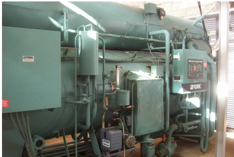
Figura 1.5. Chiller de absorção de simples efeito usado no SENAI, de Natal, RN, para a climatização do prédio.
