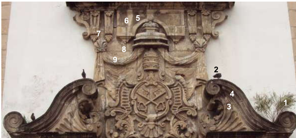
Figura 3.39 - Patologias localizadas e numeradas sobre a superfície dos blocos que compõem os elementos da parte da composição denominada coroamento. Fonte: autor.
