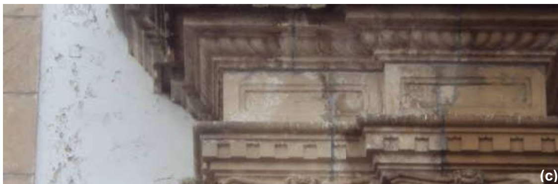
Figura 3.37 – Igreja de São Pedro dos Clérigos/Pórtico central. Patologias identificadas sobre a superfície, conforme o elemento, dos blocos componentes do entablamento. Fotos: (a) 1-lasca e 2-crosta negra; (b) 3-coloração; (c) 4-incrustação. Fonte: autor.
