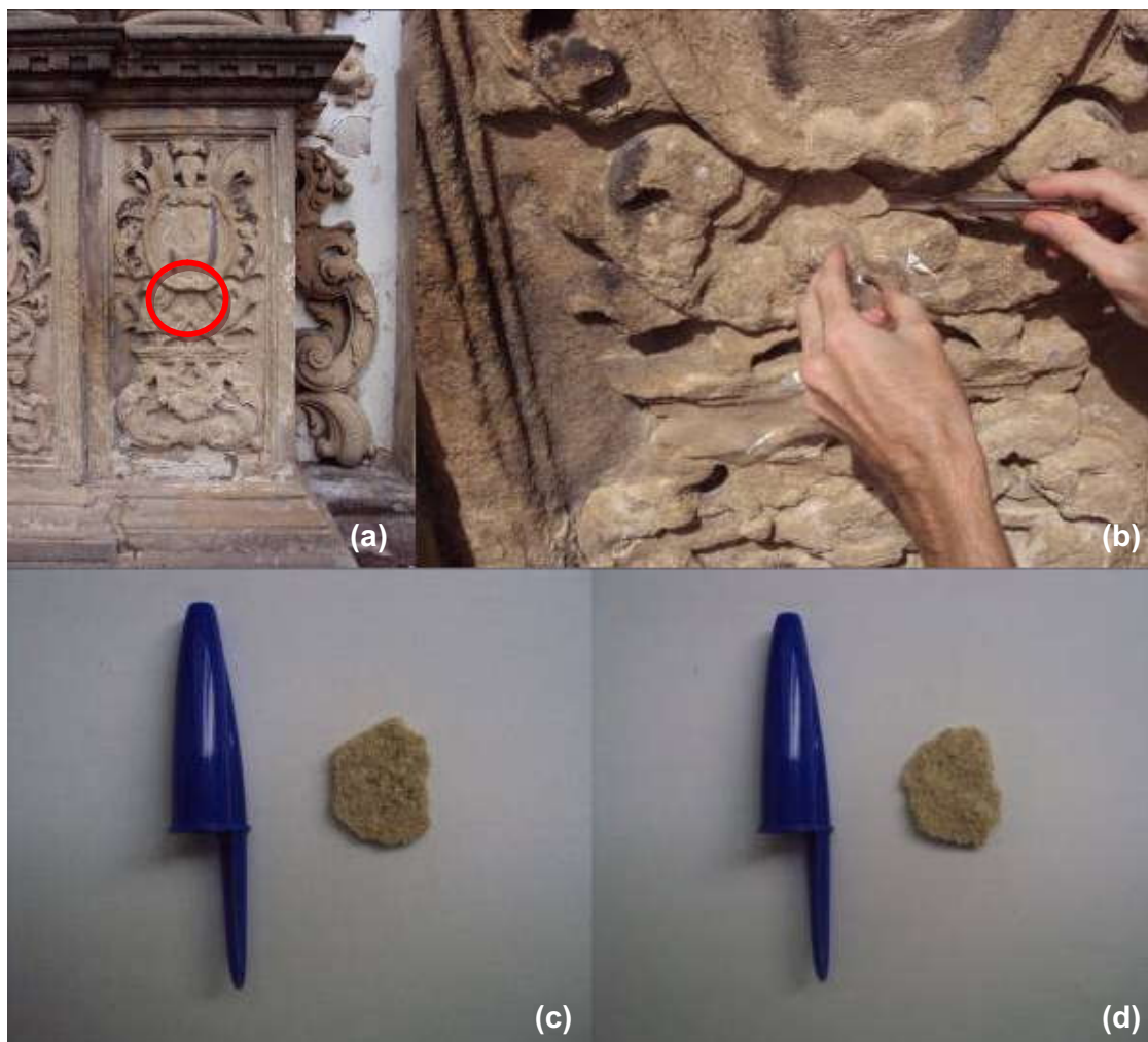
Figura 3.3 - Amostra 01 coletada no frontispício da ISPC. (a) e (b) local da coleta – pórtico central, pedestal lado esquerdo, dado; (c) e (d) amostra 01 - (c) superfície exposta; (d) superfície interna. Fonte: autor.
