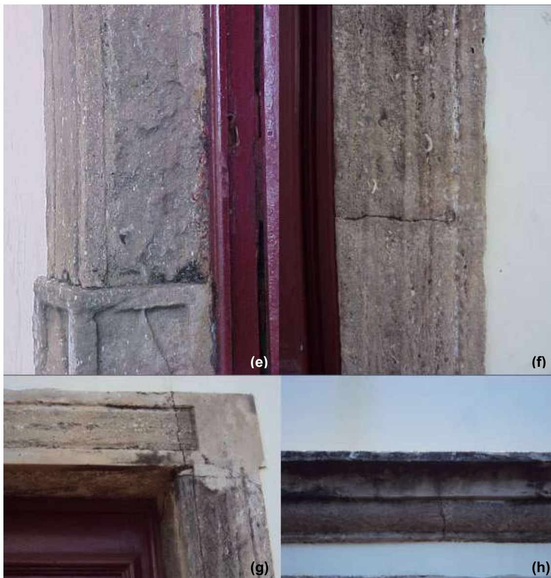
Figura 3.54 – Igreja de Nossa Senhora da Piedade/Portada lateral direita. Patologias identificadas sobre a superfície dos blocos que compõe as partes da composição do bem integrado denominado portada lateral direita. Foto (e) bloco B2 - 4 - erosão - ilhargá; (f) bloco B5 - 5 - fratura, alveolização e erosão; (g) bloco B3 - 6 - fratura, intervenção em argamassa - cimento; (h) bloco B4 - 7 - fratura, erosão e sujidade. Fonte: autor.
