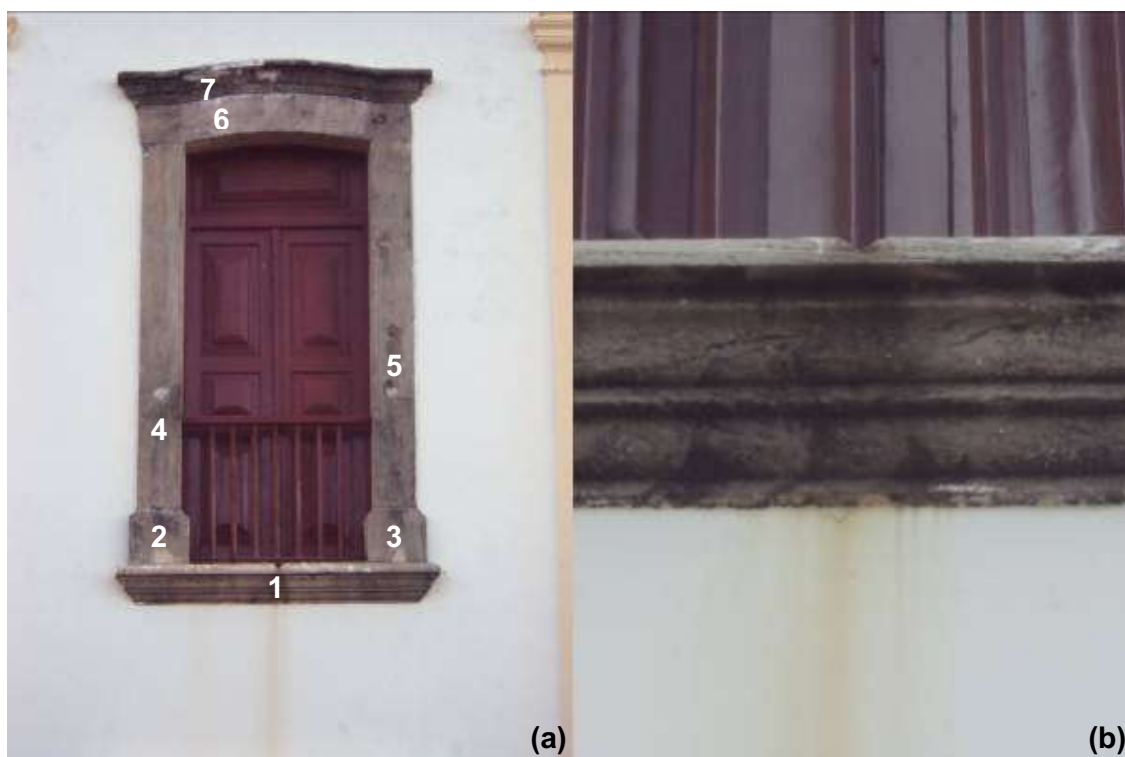
Figura 3.57 – Igreja de Nossa Senhora da Piedade/Janela da torre sineira. Patologias identificadas sobre a superfície dos blocos que compõe as partes da composição do bem integrado denominado janela torre sineira. Foto (a) objeto com a localização e numeração das patologias; (b) bloco B1 - 1 - pátina, fungo, sujeira. Fonte: autor.
