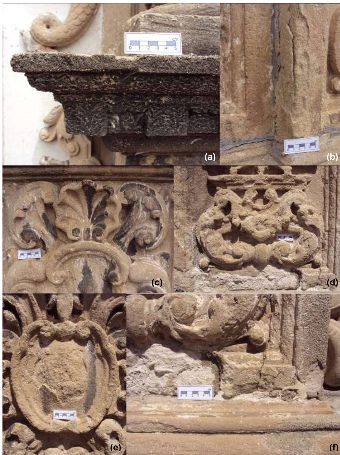
Figura 3.31 – Igreja de São Pedro dos Clérigos/Pórtico central. Patologias identificadas sobre a superfície, conforme o elemento, dos blocos componentes da base. Fotos: (a) 1-manchamento e depósito superficial; (b) 2-lascagem e descamação em placa; (c) 3-crosta negra; (d) 4-erosão; (e) 5-descamação em placa, crosta negra e erosão; (f) 6-fraturas e intervenção em argamassa – cimento. Fonte: autor.
