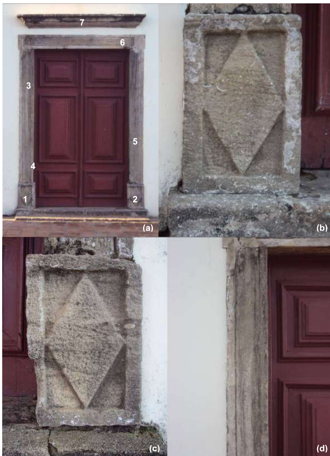
Figura 3.54 – Igreja de Nossa Senhora da Piedade/Portada lateral direita. Patologias identificadas sobre a superfície dos blocos que compõe as partes da composição do bem integrado denominado portada lateral direita. Foto (a) objeto com a localização e numeração das patologias; (b) bloco B1 - 1 - pitting, incrustação, sujidade e alveolização; (c) bloco B6 - 2 - lacuna/perda/parte faltante, pitting, arredondamento e sujidade; (d) bloco B2 – (d) 3 - alveolização, fungo e incrustação – face frontal. Fonte: autor.
