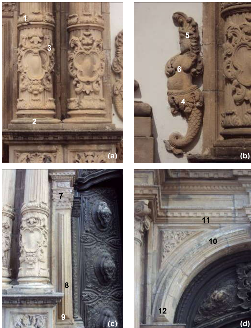
Figura 3.33 – Patologias localizadas e numeradas sobre a superfície dos blocos que compõem os elementos da parte da composição denominada corpo. Fotos: (a) coluna esquerda interna – base ática e fuste terço inferior; (b) applique antropomorfo direito; (c) pé direito – cercadura direita e (d) arco pleno – cercadura direita. Fonte: autor.
