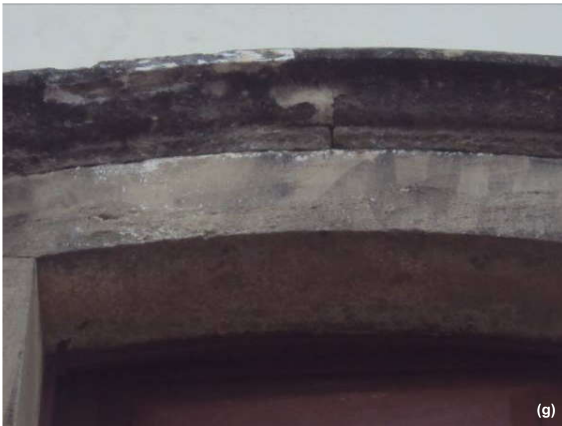
Figura 3.57 – Igreja de Nossa Senhora da Piedade/Janela da torre sineira. Patologias identificadas sobre a superfície dos blocos que compõe as partes da composição do bem integrado denominado janela torre sineira. Foto (g) bloco B4 e B5, sendo, respectivamente: 6 - alveolização, incrustação e pitting (intradorso) e 7 - crosta negra, descamação e perda. Fonte: autor.
