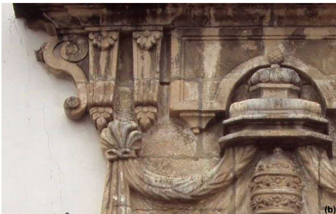
Figura 3.40 – Igreja de São Pedro dos Clérigos/Pórtico central. Patologias identificadas sobre a superfície, conforme o elemento, em alguns blocos componentes do coroaamento. Fotos: (a) bloco B49 - 1-presença de vegetação – porte pequeno; 2-presença de animais - pombos; 3-fratura; 4-crosta negra; (b) bloco B39 - 5-crosta negra; 6-incrustação; bloco B38 - 7-pitting; 8-intervenção em argamassa sobre as juntas - cimento; bloco B37 - 9-excremento. Fonte: autor.
