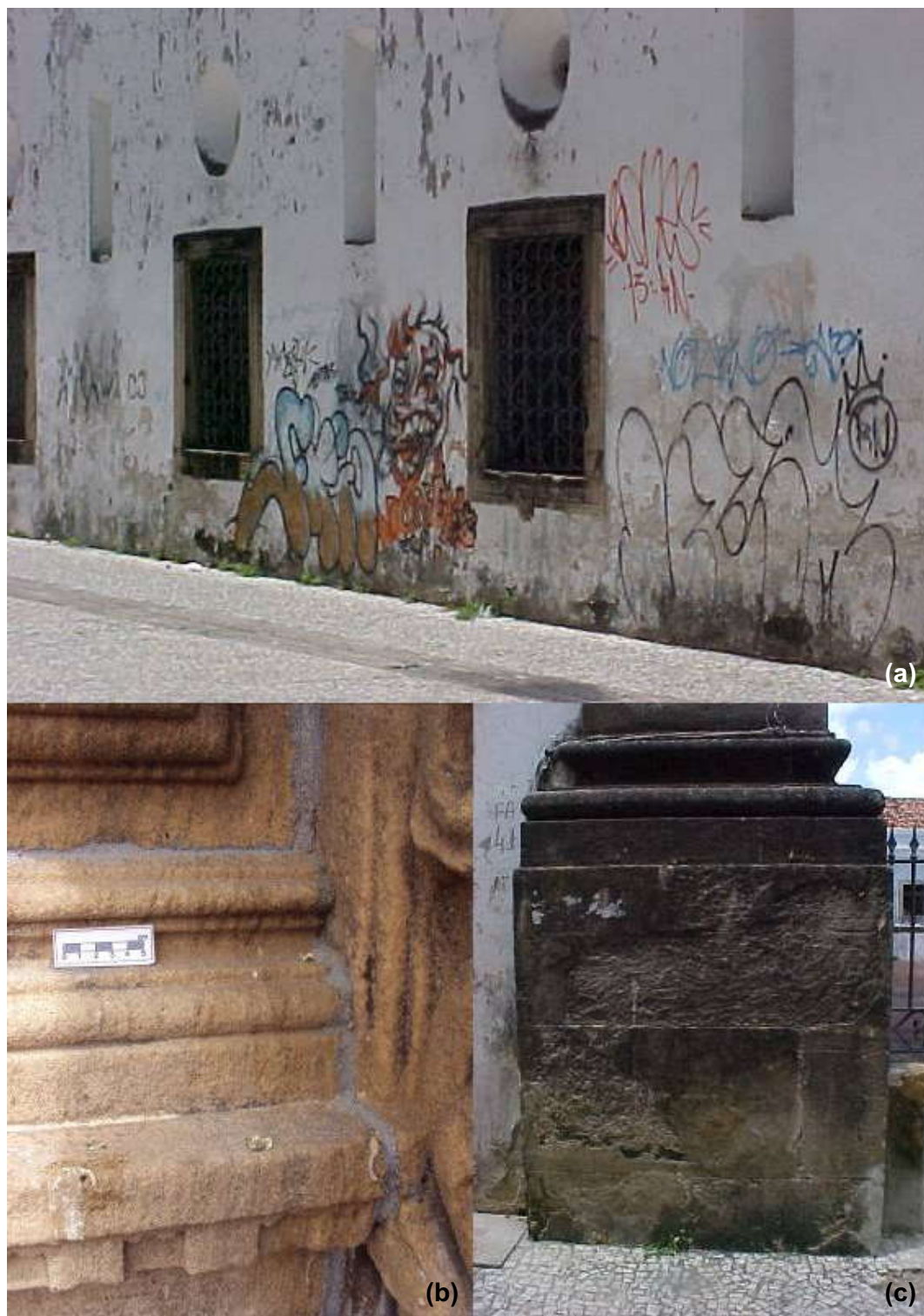
Figura 3.25 - Igreja de São Pedro dos Clérigos; fatores antrópicos causados pela ação humana. (a) ato de vandalismo com a pichação das paredes – fachada lateral direita; (b) e (c) intervenção técnica com o uso de materiais inadequados; (b) material não identificado usado para vedação das juntas entre os blocos – pórtico central; (c) argamassa em cimento cobrindo parte com perda da substância pétrea – cunhal direito, pedestal, parte inferior esquerda. Fonte: autor.
