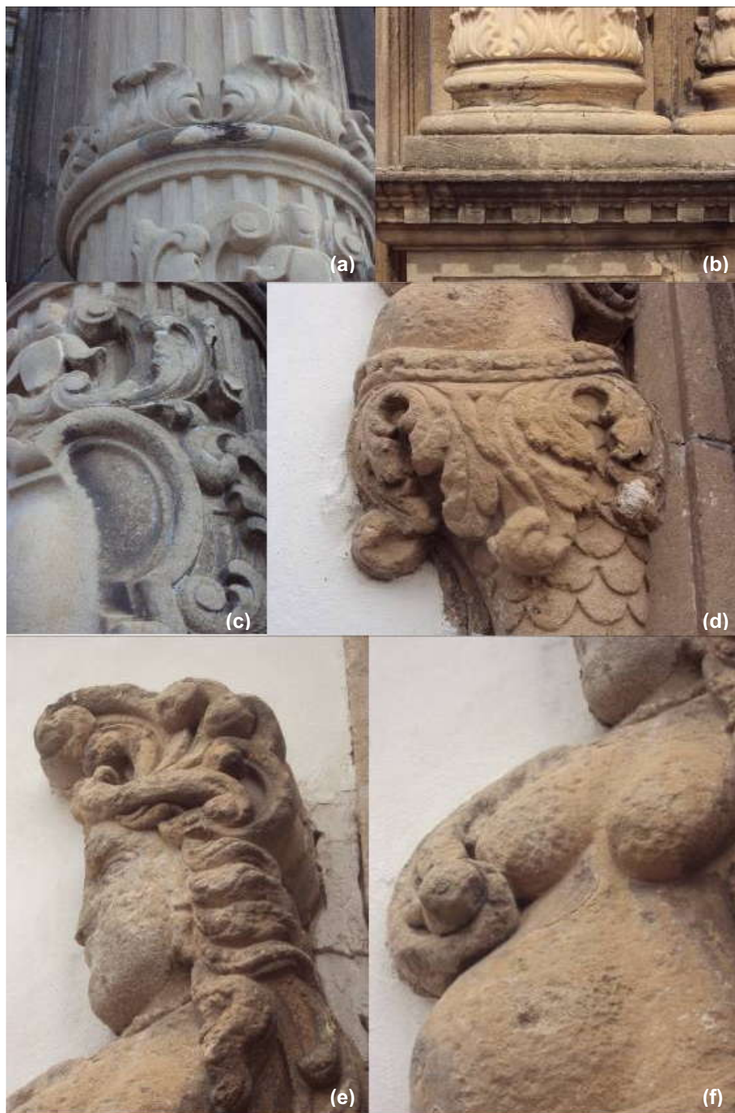
Figura 3.34 – Igreja de São Pedro dos Clérigos/Pórtico central. Patologias identificadas sobre a superfície, conforme o elemento, dos blocos componentes do corpo. Fotos: (a) 1-fungo, perda e intervenção em argamassa - cimento; (b) 2-fraturas; (c) 3-crosta negra - cimento; (d) 4-erosão; (e) 5-intervenção em argamassa - cimento, incrustação, pitting, crosta negra; (f) 6-pitting. Fonte: autor.
