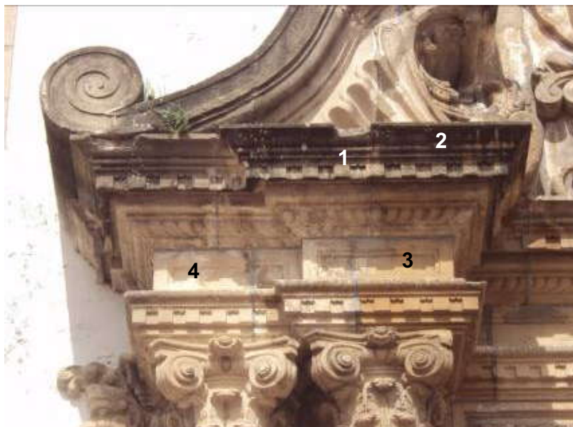
Figura 3.36 - Patologias localizadas e numeradas sobre a superfície dos blocos que compõem os elementos da parte da composição denominada entablamento. Foto: entablamento lado direito – cornija; arquitrave e friso. Fonte: autor.
