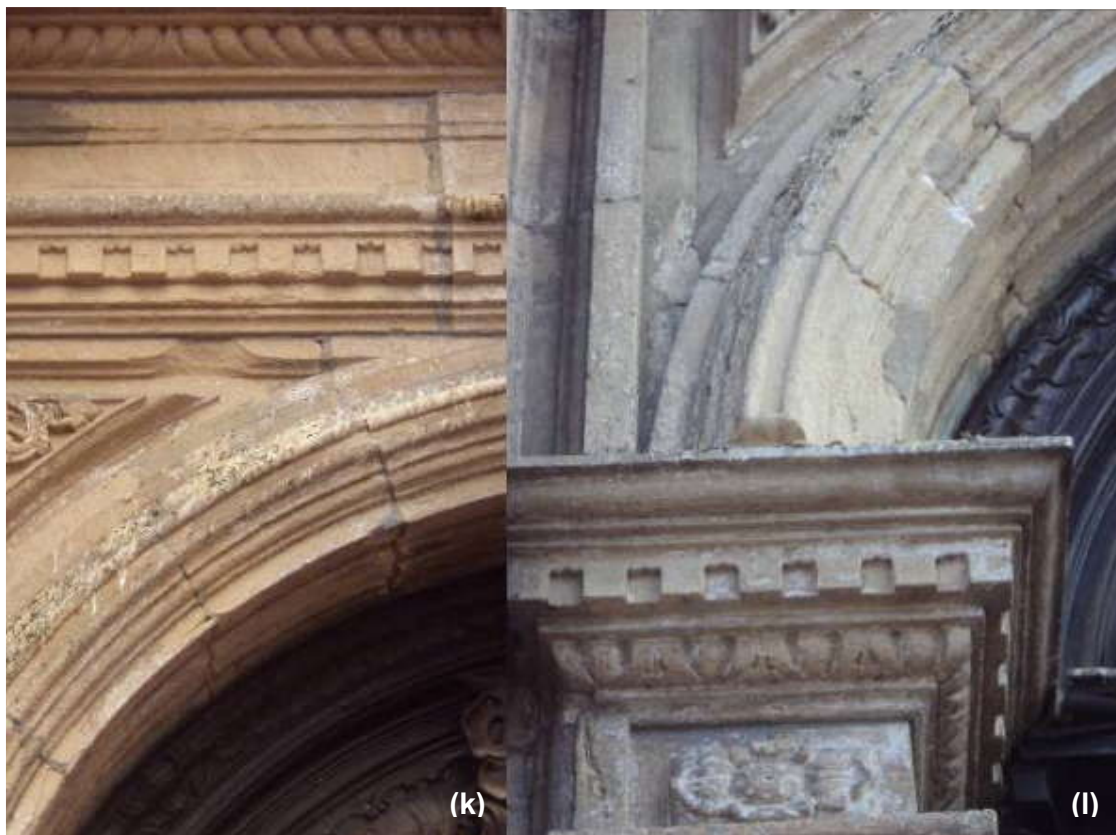
Figura 3.34 – Igreja de São Pedro dos Clérigos/Pórtico central. Patologias identificadas sobre a superfície, conforme o elemento, dos blocos componentes do corpo. Fotos: (k) 11-lasca e (l) 12-pitting, erosão, excrementos e intervenção em argamassa - cimento. Fonte: autor.
