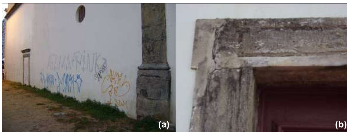
Figura 3.26 – Igreja de Nossa Senhora da Piedade; fatores antrópicos causados pela ação humana. (a) ato de vandalismo com a pichação das paredes e cantaria (pilastra) – fachada lateral esquerda; (b) intervenção técnica com o uso de materiais inadequados; argamassa em cimento cobrindo parte do bloco com perda da substância pétreas – portada lateral direita, verga, extremo lateral e aresta inferior- frontispício. Fonte: autor.
