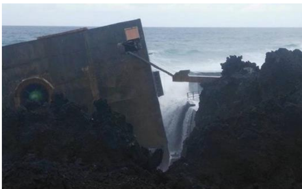
Figura 8 – Usina de Pico em colapso em abril de 2018
