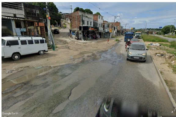
Figura 35 - Buracos no trecho da PE-015
