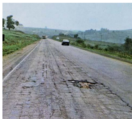
Figura 34 - Defeitos diversos no pavimento
