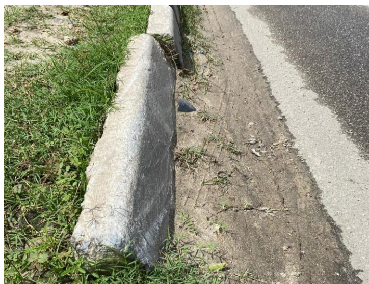
Figura 29 - Meio-fio-sarjeta obstruído por sedimentos no dia 24 de abril de 2023
