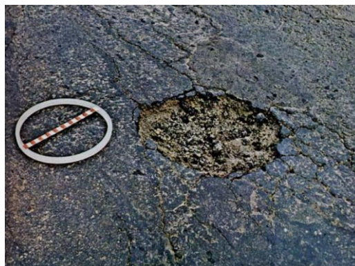
Figura 36 - Painela/buraco no pavimento
