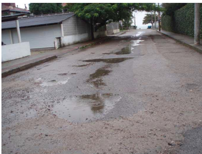
Figura 22 - Alagamento causado por falha na pavimentação
