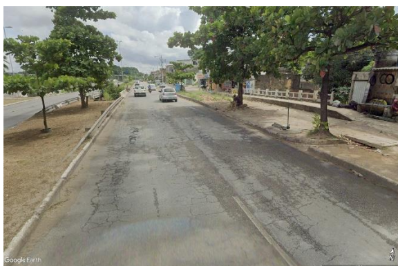
Figura 33 - Defeitos no pavimento do trecho
