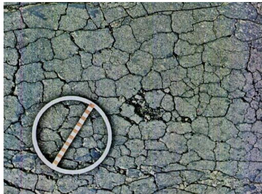
Figura 32 - Trinca interligada, tipo jacaré
