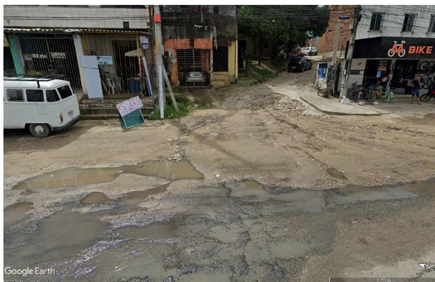
Figura 27 - Água acumulada na entrada da Rua Piscina
