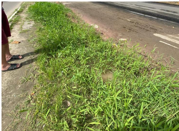
Figura 30 - Valeta V01 com água acumulada da precipitação no dia 24 de abril de 2023
