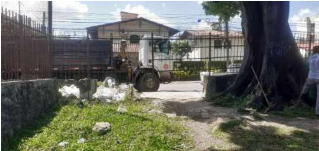
Figura 3.4 / Ponto C - O trecho danificado do muro localizado próximo ao "laguinho" da UFPE.
