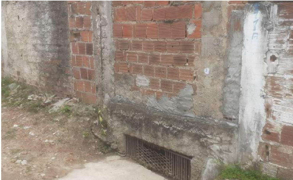
Figura 3.5 / Ponto D - Ocupação irregular sobre a calha do Riacho do Cavouco.
