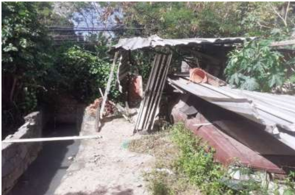
Figura 3.6 / Ponto E- Ocupação irregular da calha do Riacho do Cavouco e saída da galeria subterrânea da rua Amaro Gomes Poroca.
