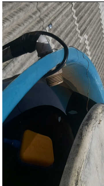
Figura 47: Boia desligando o sistema devido ao nível alto de água na caixa.
