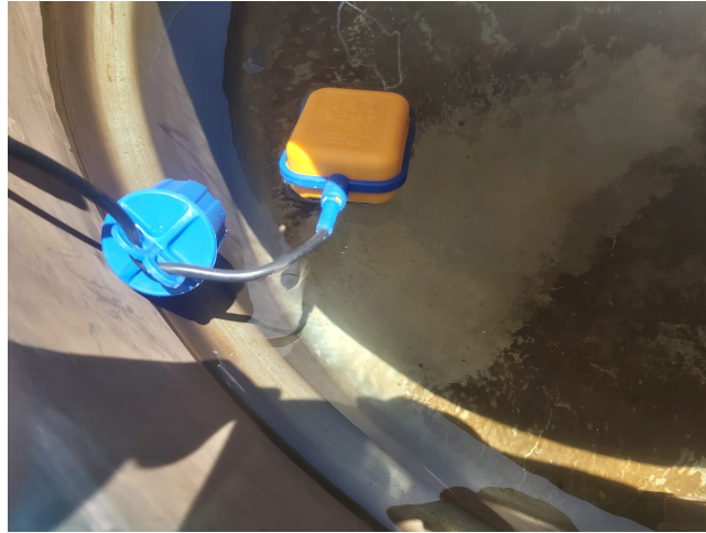
Figura 39: Bóia dentro da caixa d'água.
