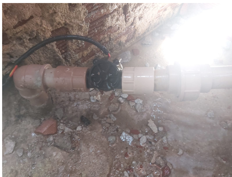
Figura 42: Sensor de fluxo instalado na encanação.
