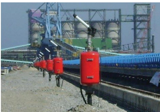
(e) Via de acesso com aspersores.
