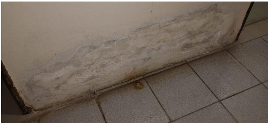
Figura 16: Infiltração na base de outra parede da circulação.
