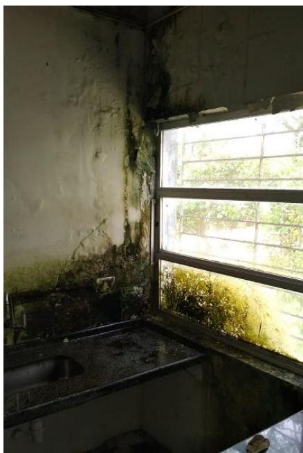
Figura 07: Presença de mofo na copa.
