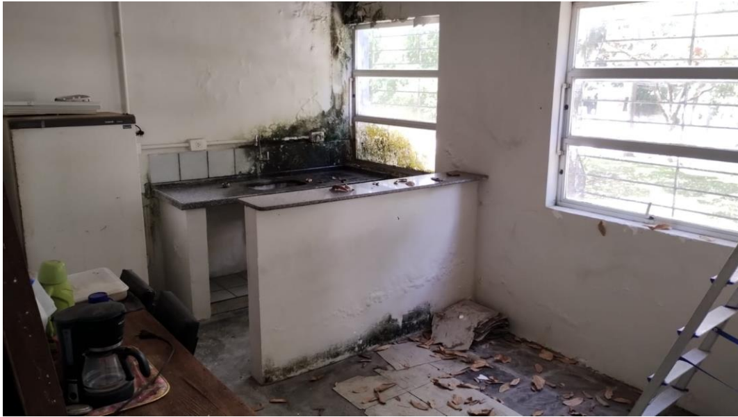
Figura 27: Infiltração na copa do andar superior.
