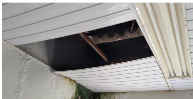
Figura 08: Abertura existente no forro da copa.
