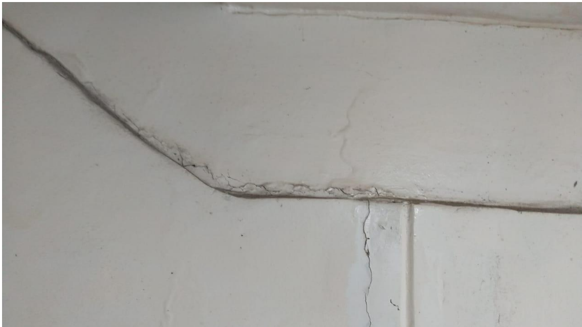
Figura 13: Fissuras observadas em um encontro de viga e pilar na escada do prédio.
