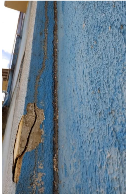
Figura 18: Rachadura em pilar na parte externa na entrada do LDN.
