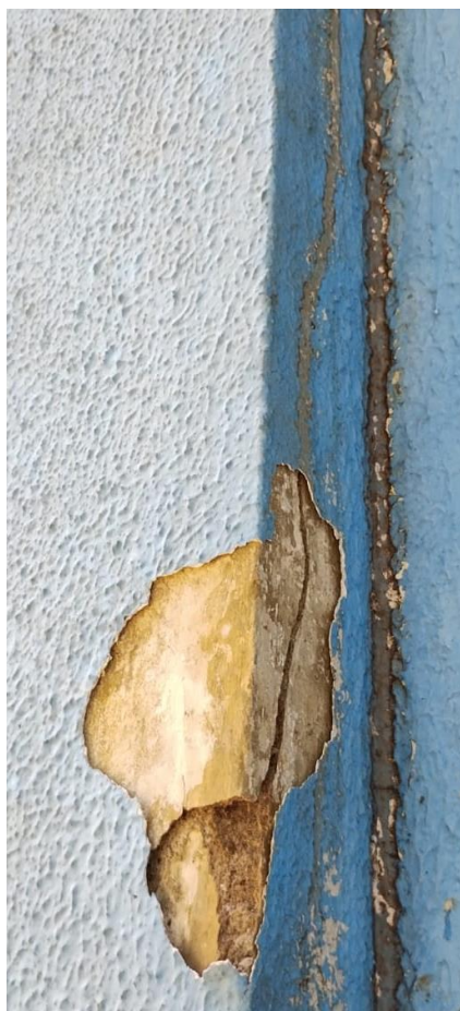
Figura 32: Fissura no pilar 27.
