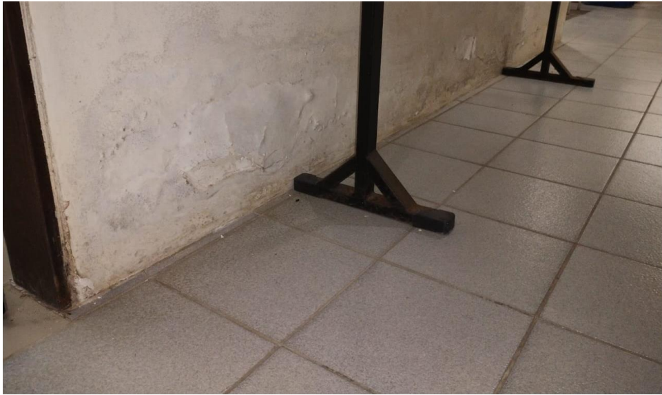
Figura 15: Infiltração na base da parede da circulação.
