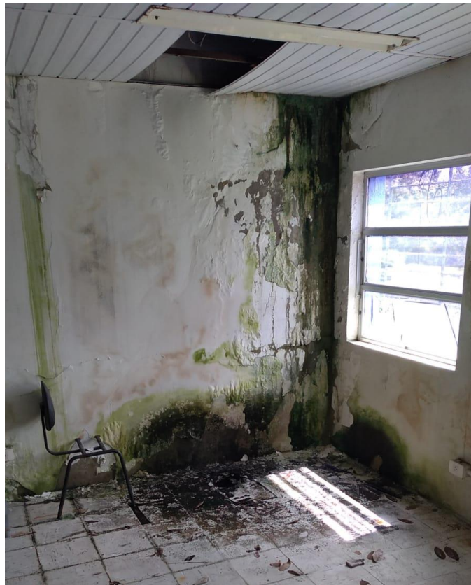
Figura 28: Infiltração na sala de aula da pós-graduação no andar superior.
