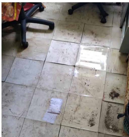
Figura 10: Presença de água no piso.
