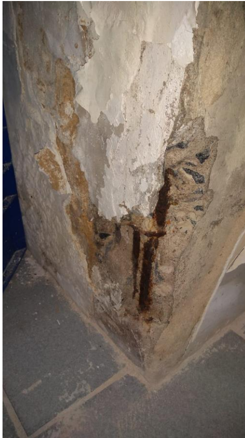
Figura 14: Pilar com armadura exposta próximo a escada.
