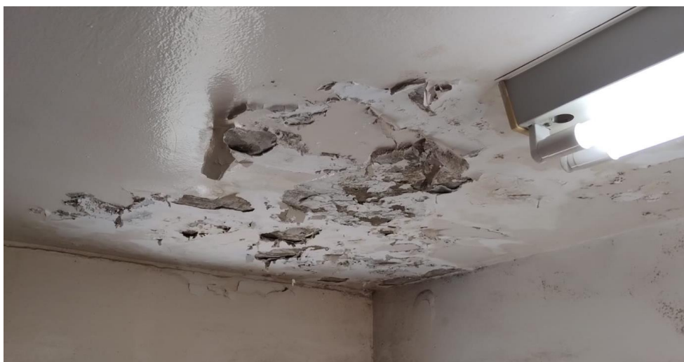
Figura 31: Infiltração na laje sobre a escada.
