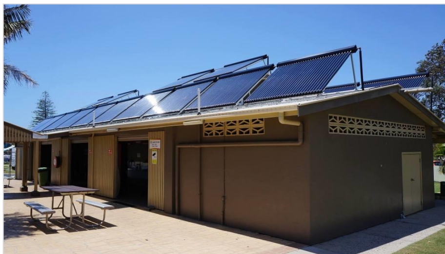
Figura 41 – Conjuntos de aquecedores solares de água divididos com tubo evacuado para restaurantes nas Ilhas Maurício
