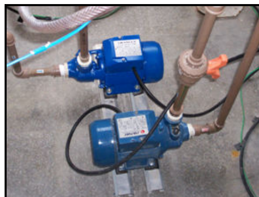
Figura 4.10 – Bombas centrífugas para a recirculação de água.
