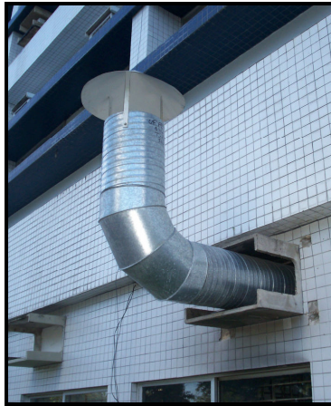
Figura 4.8 – Duto de exaustão da torre.
