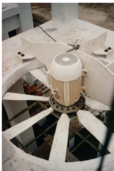
1.14 – Motor axial de uma torre de tiragem induzida (Fonte: www.TorresDeEnfriamiento.com )
