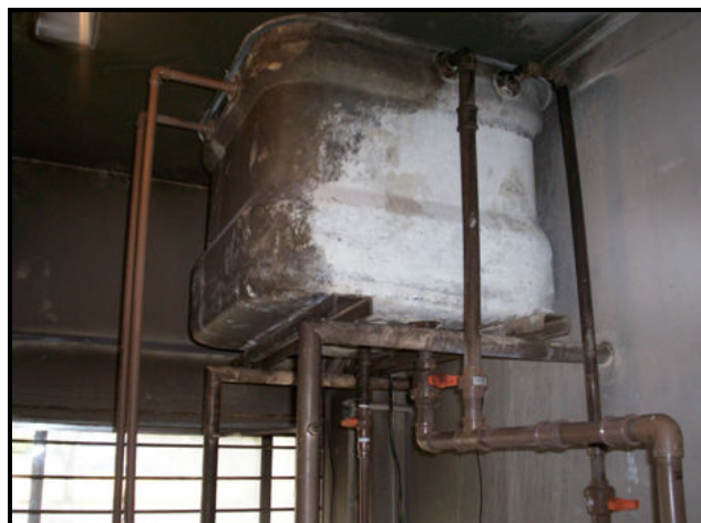
Figura 4.5 – Reservatório de água quente.
