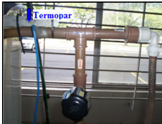
Figura 4.12 – By-pass para controle da vazão e termopar da água quente.
