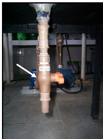
Figura 4.15 – Válvula esfera de fechamento da desconcentração (blowdown).
