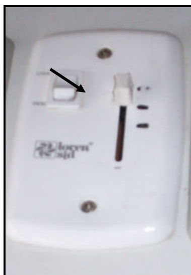
Figura 4.22 – Potenciômetro (Dimmer) para controle da vazão de ar.
