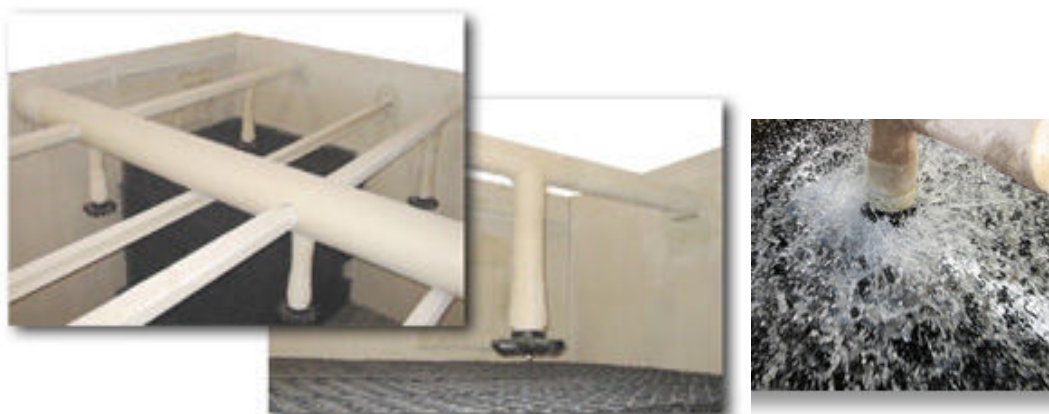
Figura 1.15 – Sistemas de distribuição de água por pressão (Fonte: www.sj.cefetsc.edu.br/~jesue/torres%20arrefecimento.ppt ).
