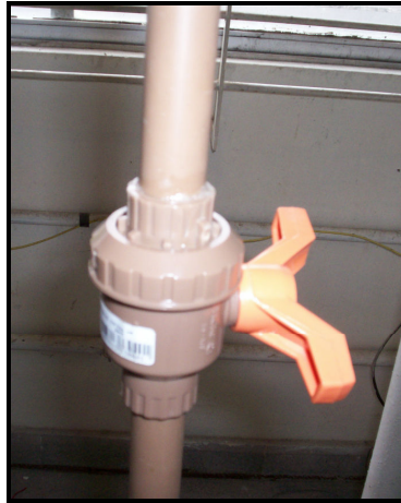
Figura 4.6 – Válvula esfera para regulação da vazão.
