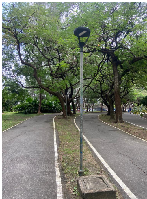
Figura 75: Poste com iluminação de LED.
