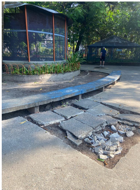
Figuras 37: Piso degradado próximo ao lago.
