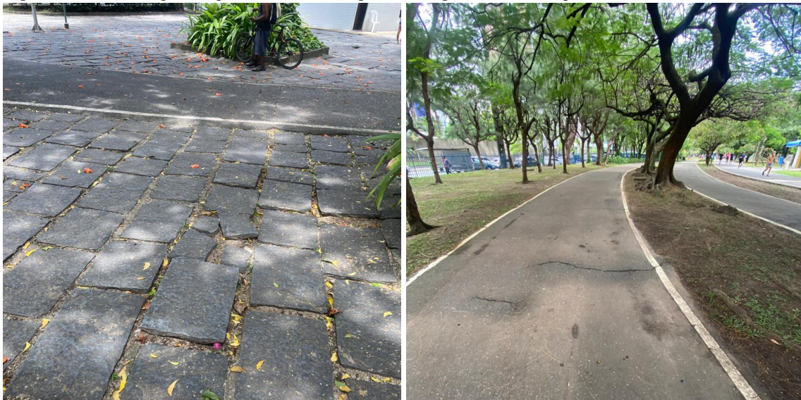
Figura 73 e 74: À esquerda, piso em rochas de granito irregular. À direita, pista de corrida com rachaduras.
