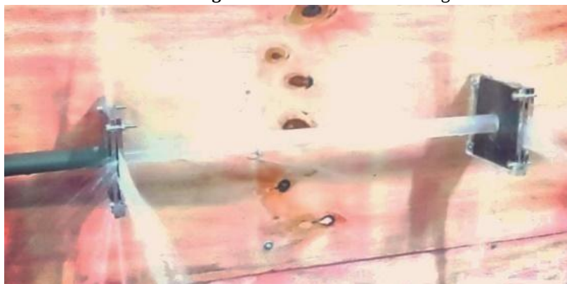
Figura 22 – Vazamento nos flanges
