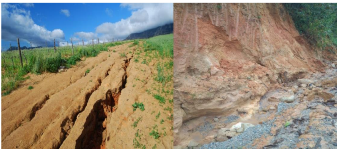
Figura 12. Imagens da erosão na comunidade.
