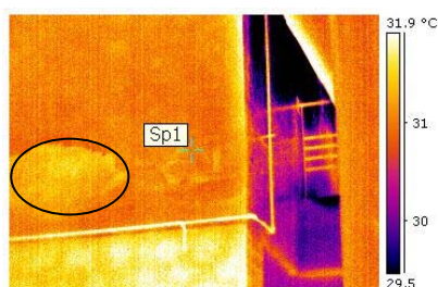
Figura 3.9 – Visualização de descolamento de pastilhas em fachada [extraído de Magnani et al. (2005)]
